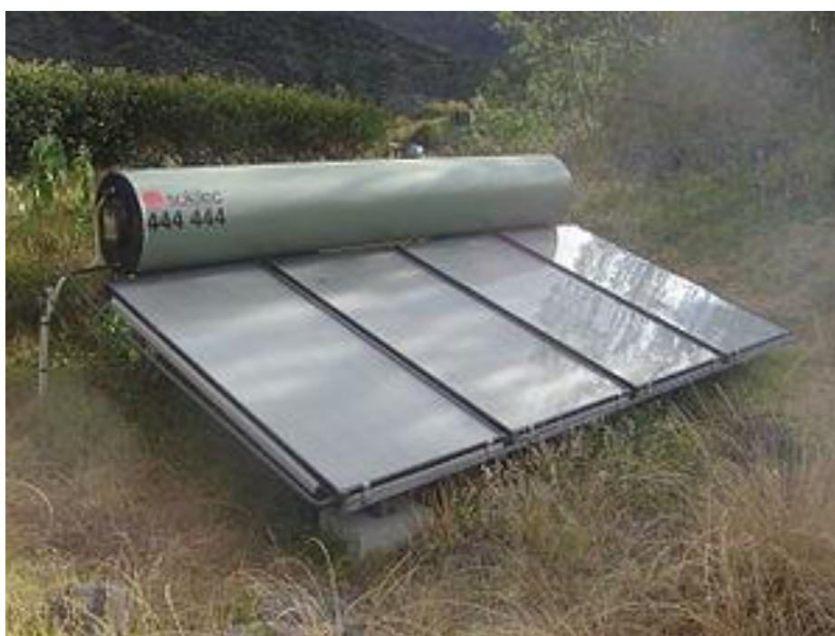
Fig. 1.3.5 : Pannello solare termico
