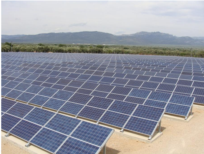
Fig.1.3.6: Imponente distesa di pannelli fotovoltaici nel comune di Modena
