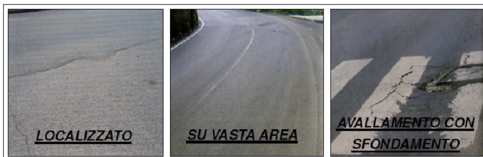
Figura 1.8 – Fenomeno dei cedimenti in una pavimentazione stradale
