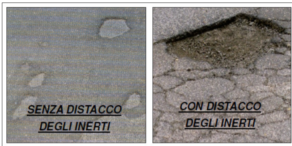
Figura 1.10 – Fenomeno delle buche in una pavimentazione stradale
