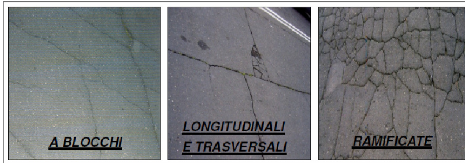
Figura 1.6 – Fenomeno delle fessurazioni in una pavimentazione stradale
