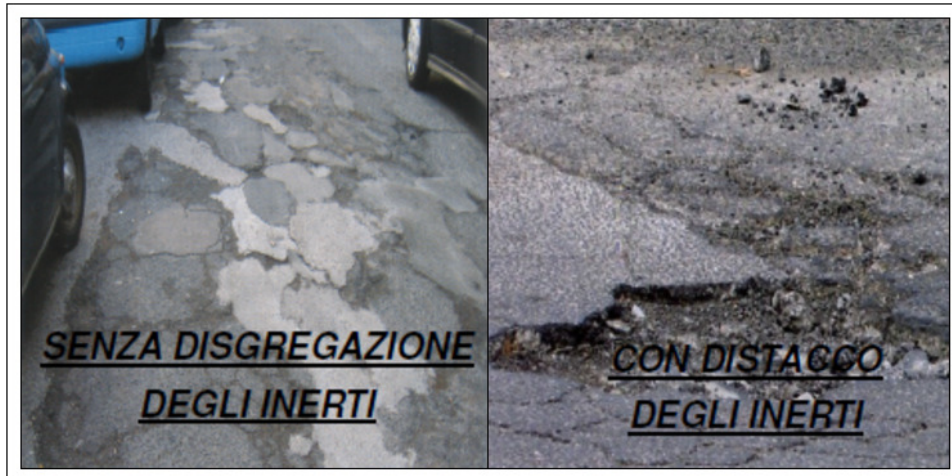
Figura 1.9 – Fenomeno dei dissesti in una pavimentazione stradale
