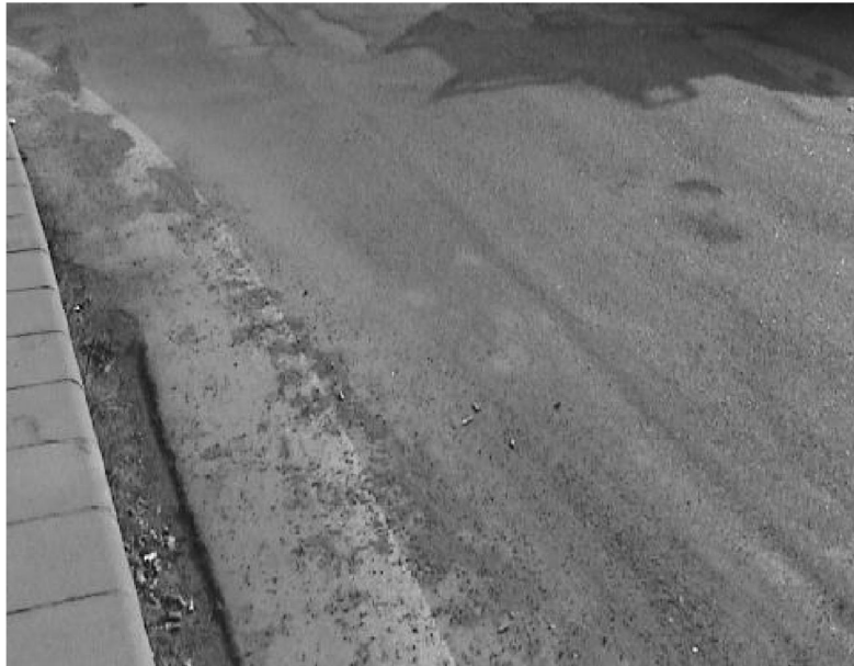
Figura 1.2 – Disgregazione e distacco degli inerti
