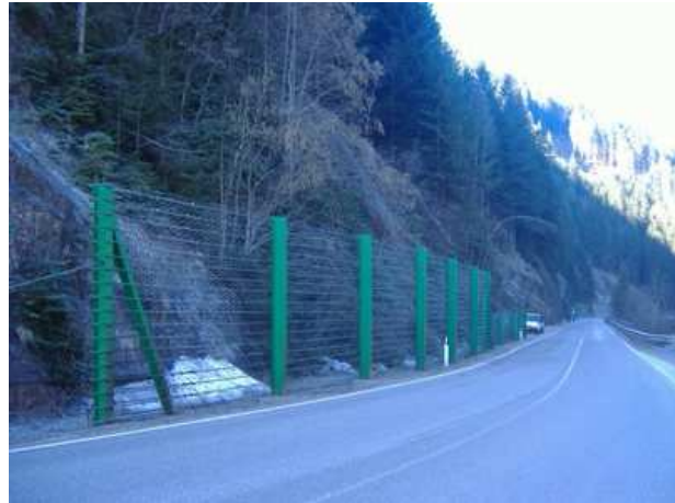
Figura 11 - barriera paramassi rigida a funi
