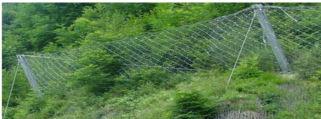
Figura 69- esempio di barriera paramassi danneggiata in seguito a riempimento ad opera di materiale vegetativo
