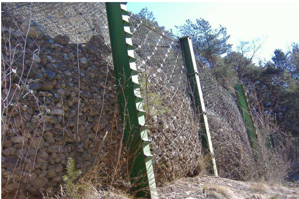
Figura 137 - esempio di barriera paramassi piena di materiale lapideo
