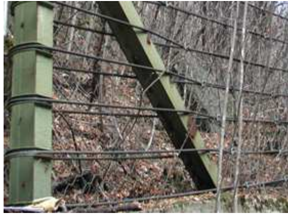
Figura 57 - esempio di barriera soggetta a corrosione
