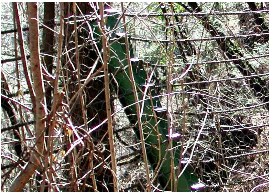
Figura 55 - Danneggiamento di una barriera in seguito ad evento : montante lesionato
