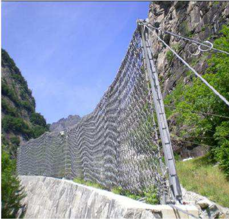
Figura 10 - barriera paramassi elastica
