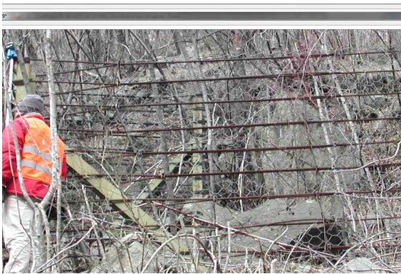
Figura 59 - esempio di barriera danneggiata in seguito ad usura : montanti e funi arrugginite
