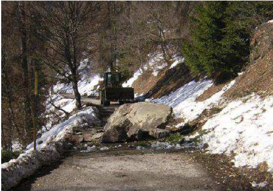
Figura 1- esempio di frana da crollo
