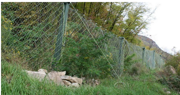
Figura 68 - esempio di barriera danneggiata a causa di riempimento lapideo e vegetativo. si noti la presenza a valle della barriera di materiale lapideo
