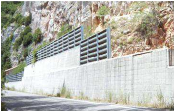
Figura 9 - barriera paramassi rigida
