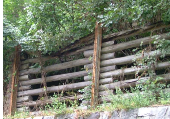
Figura 60 - esempio di barriera danneggiata in seguito ad usura : decomposizione
