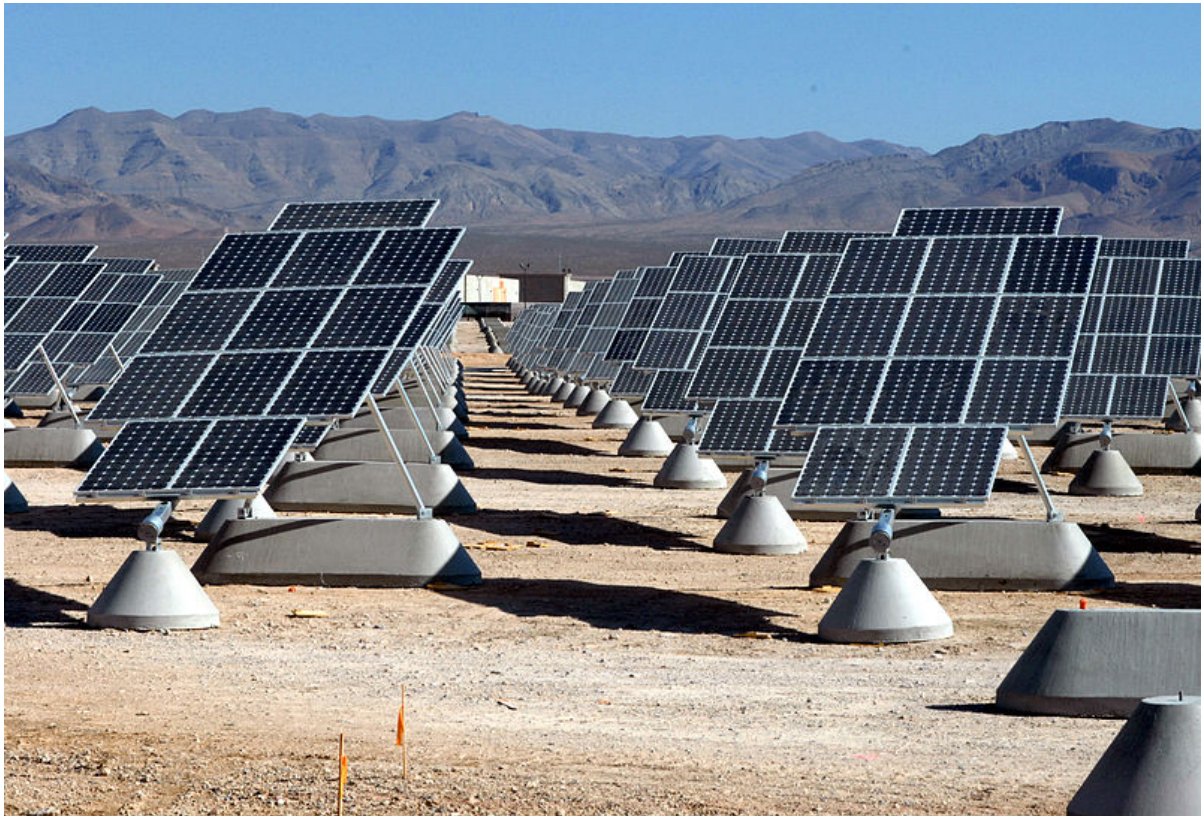
Figura 1: Impianto di celle fotovoltaiche al silicio al Nellis Solar Power Plant, all'interno del Nellis Air Force Base in Nevada, USA. Si tratta di circa 6000 pannelli, capaci di ruotare per orientarsi nella direzione del Sole e di garantire una potenza di picco complessiva di circa 14 \text{ kW} [1].
