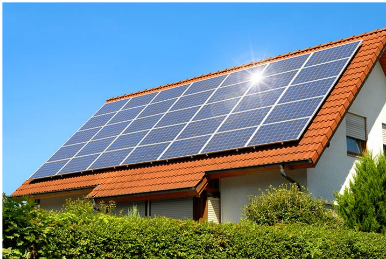
Figura 12 Pannello solare di una abitazione
