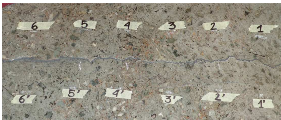
Figura 4.1 Una crepa del solaio della sala Rossa: è possibile notare il materiale di riempimento nella crepa
