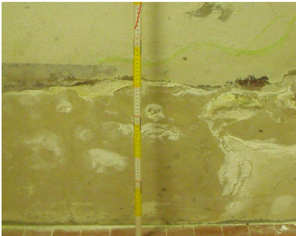
Figura 9.10 Particolare della parete davanti agli ascensori: notevole presenza di efflorescenze.
