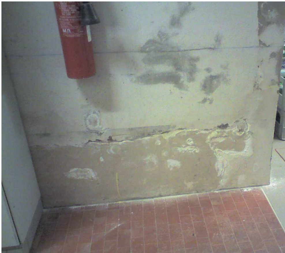
Figura 9.1 Parete in zona ascensori: si osserva la presenza di efflorescenze.
