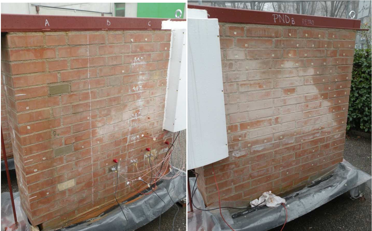
Figura 10.28 Muretto PNDB: livello di salamoia (cloruro di sodio 0,05%) in vasca e condizioni superficiali del fronte (a sinistra) e del retro (a destra) durante l'acquisizione del 02/12 con antenna 900 MHz.
