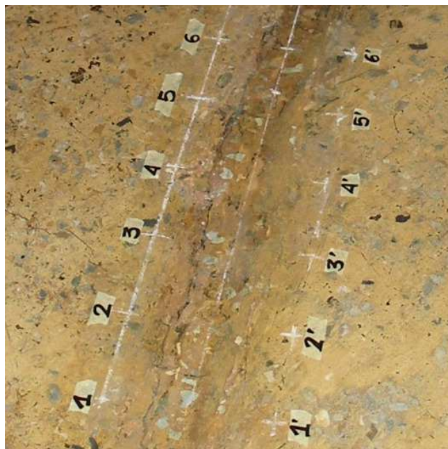
Figura 4.8 Immagine dell'Area B: si osserva la notevole larghezza della fessura ristilata e l'ipotetico asse di questa contrassegnato tramite linea in gesso.
