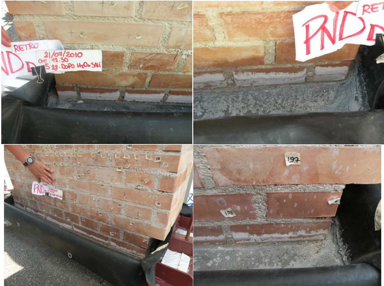
Figura 10.24 Depositi di sale (solfato di sodio al 5%) visibili sul muretto PNDD il 21/07/2010 alle ore 12:30: angolo destro e sinistro del retro (in alto), fronte ed angolo destro del fronte (in basso).
