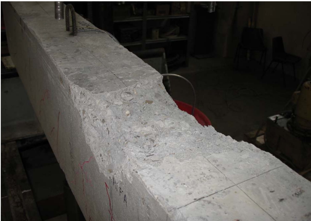
Figura 5-23: TS2 – particolare della zona di rottura
