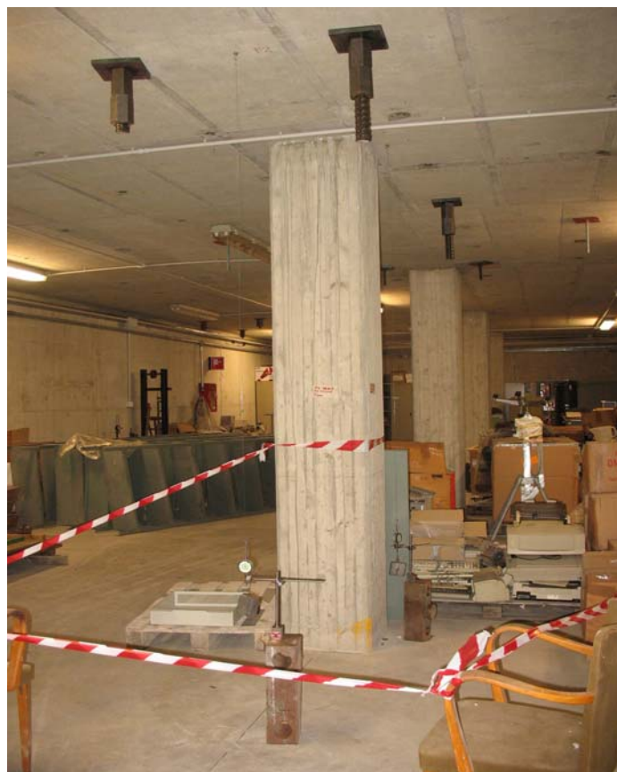
Figura 11.22: trasduttori a filo F1 e F2 per la misurazione dell'abbassamento del solaio
