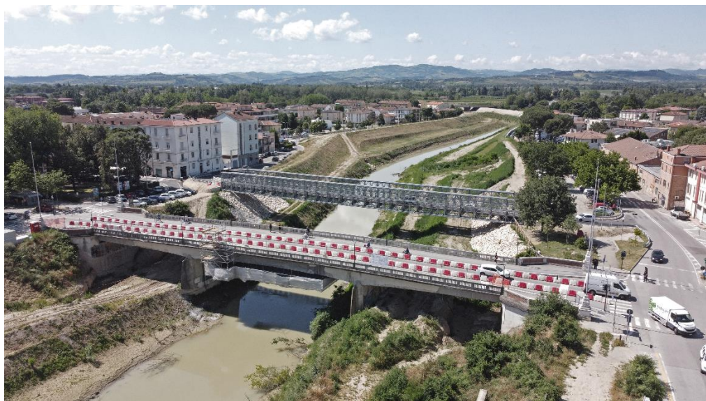
Figura 1.61 Il Ponte provvisorio a fianco del Ponte delle Grazie, riaperto in attesa del progetto di demolizione e ricostruzione
