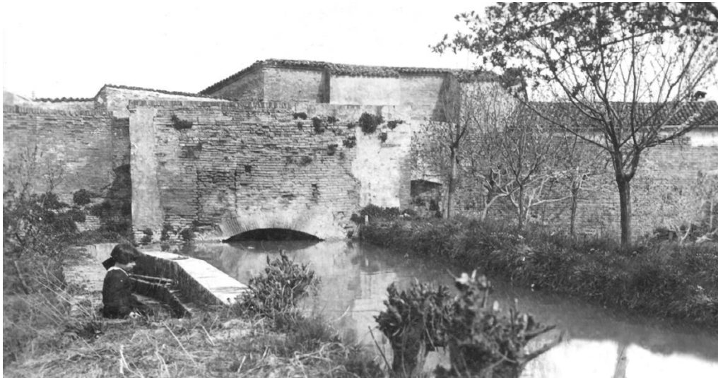
Figura 3.17 La torretta rompitratta con il canale in ingresso (da notare l'arco oggi murato) (collezione Calzi - Biblioteca Manfrediana)
