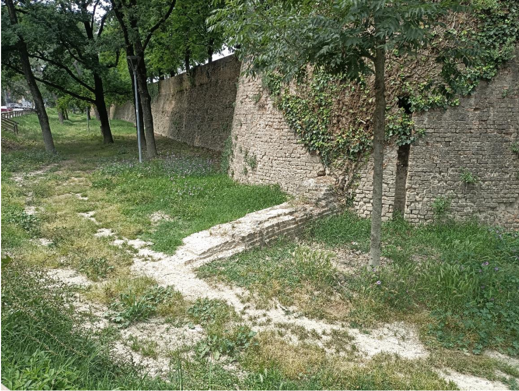
Figura 1.82 Ruederi di un muraglione utilizzato come chiusa per risolvere la pendenza del fossato
