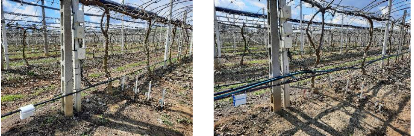
Fig. 7 Centraline e sensori per il monitoraggio dell'umidità del terreno e del volume d'acqua erogato, installati nelle tesi ad ala singola (T0 e T1, foto sinistra) e ad ala doppia (foto destra)
