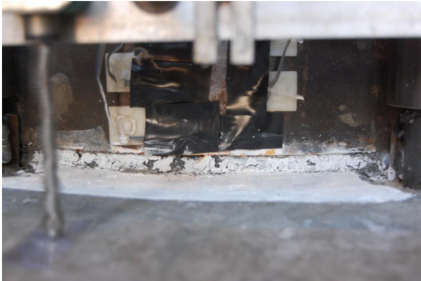
Fig. 4.19 - Formazione di scaglie superficiali sulla malta del giunto
