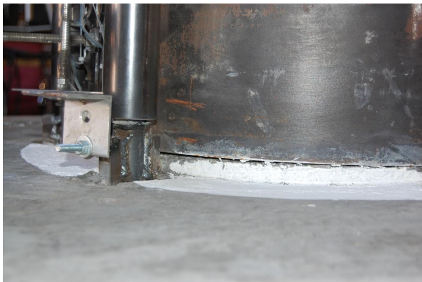
Fig. 4.20 – Apertura del gap fra la colonna e la malta durante lo spostamento laterale
