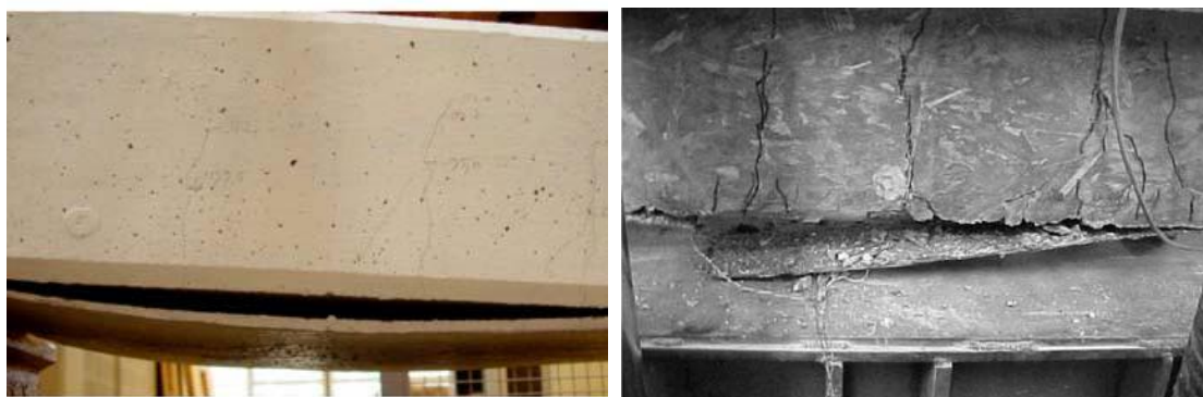
Figura 43 Delaminazione di travi in calcestruzzo rinforzate con e SRG
