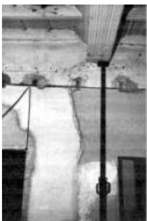
Figura 22 Effetto di carichi concentrati sulla muratura
