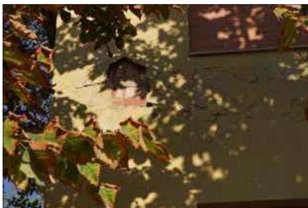
Distacco di intonaco - sopralluogo 2023
