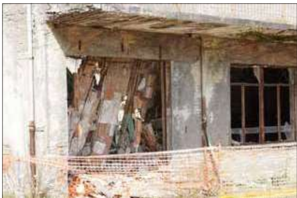
Crollo solai interni, rete che circonda lo stabile - sopr. 2023
