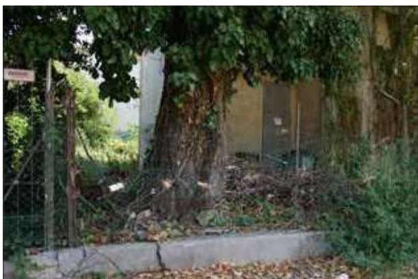
Recinzione danneggiata e rifiuti nella pertinenza - sopr. 2023
