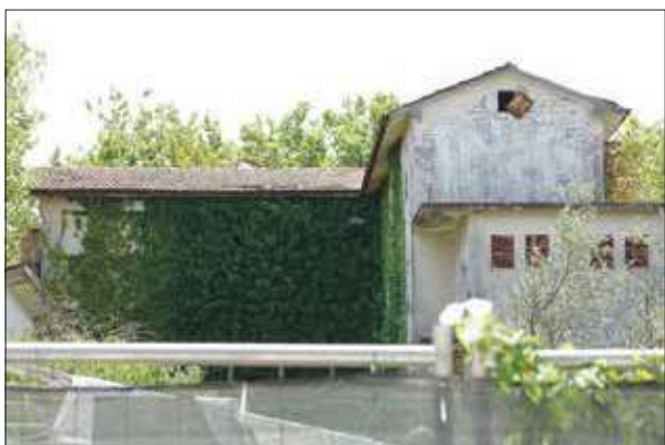
Vegetazione sull'edificio e scuri divelti - sopralluogo 2023
