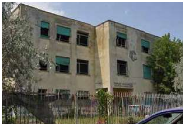
Facciata su Via C. Colombo, degrado intonaci - sopr. 2023
