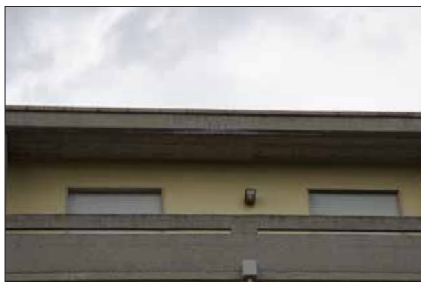
Dettaglio cementi in facciata verso Via C. Colombo sopralluogo 2023
