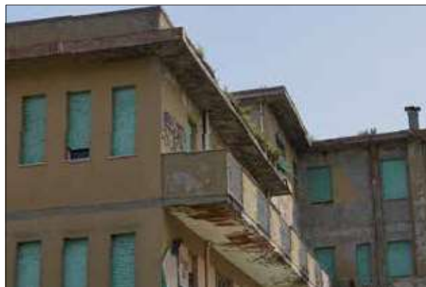
Elementi strutturali esposti e vegetazione sull'edificio sopralluogo 2023
