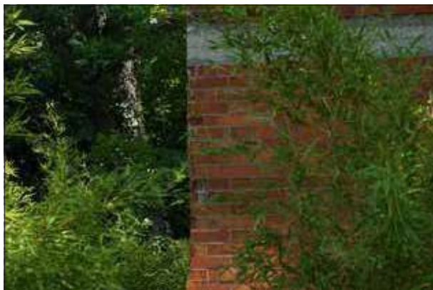
Mattoni danneggiati sullo stabile di servizio - sopr. 2023
