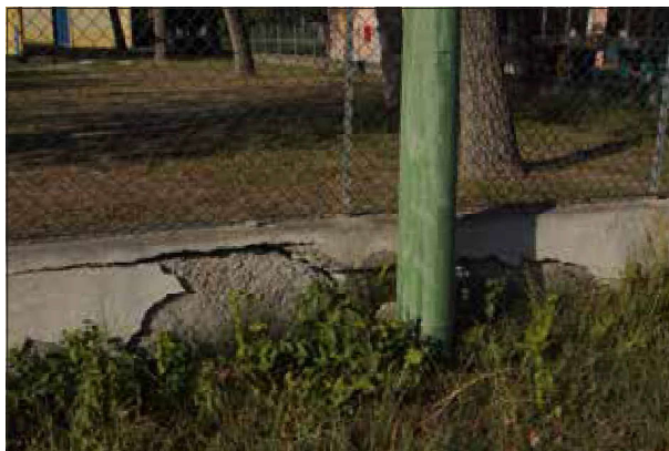
Cementi cancellata esterna - sopralluogo 2023
