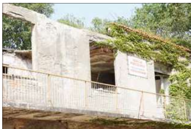
Tetto crollato, vegetazione sulla facciata - sopr. 2023
