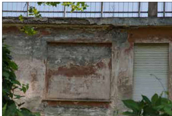
Ferri di armatura esposti distacco intonaco - sopr. 2023
