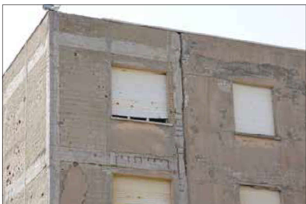
Ferri senza copriferro e distacco intonaco - sopr. 2023
