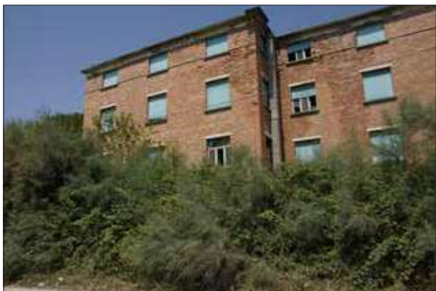
Vegetazione sulla recinzione che oscura la visuale, elementi della copertura crollati - sopralluogo 2023
