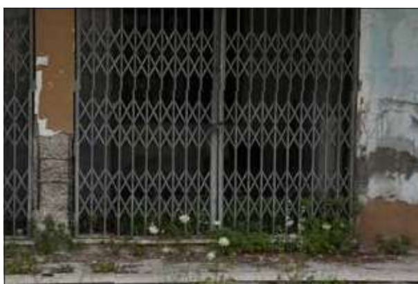
Pilastro ingresso principale con ferri esposti - sopr. 2023
