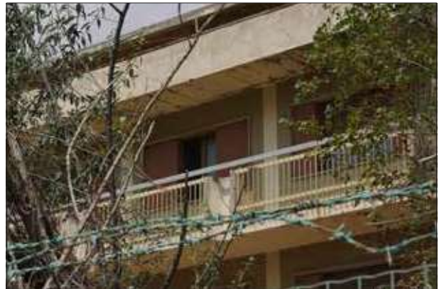
Finestre aperte e segni degrado esterni - sopralluogo 2023
