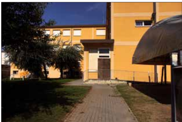
Dettaglio ingresso murato all fine della stagione estiva sopralluogo 2023
