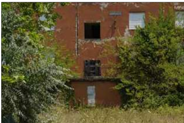
Lato Via V. de Gama con segni di degrado dello stabile sopralluogo 2023
