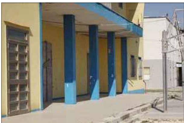
Reti poste a protezione dei cementi della facciata - sopr. 2023
