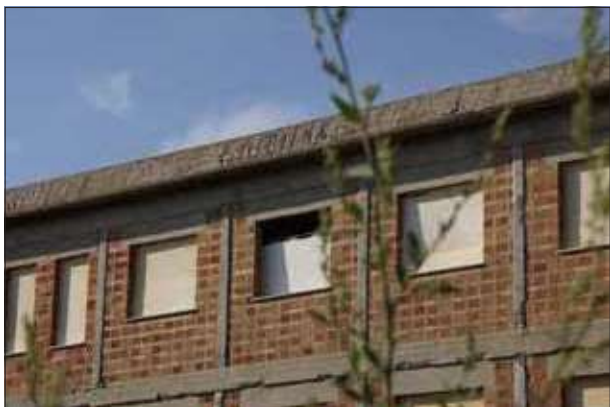
Cementi deteriorati e ferri di armatura esposti - sopr. 2023
