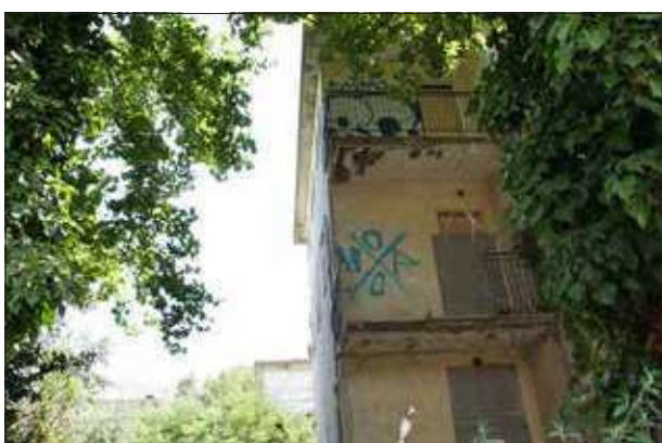
Ringhiera balcone mancante e vandalismo diffuso - sopr. 2023
