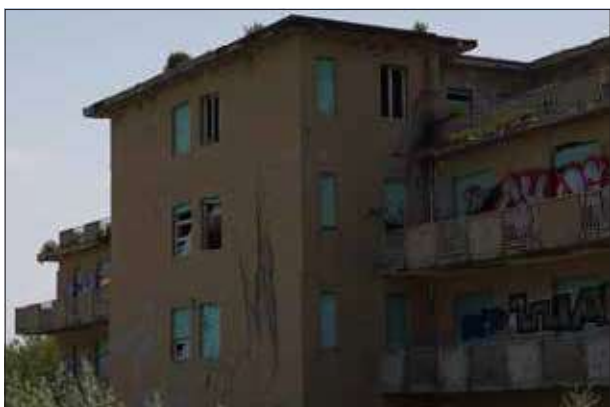
Infissi e tapparelle danneggiati e oggetti accatastati - sopr. 2023
