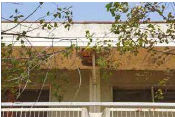
Crolli di intonaco nel sottotetto - sopralluogo 2023
