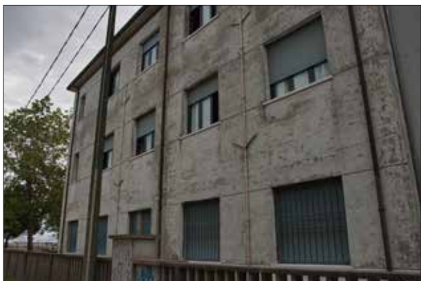
Intonaco facciata Nord - sopralluogo 2023
