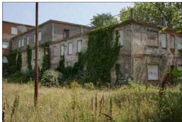
Vegetazione sullo stabile e segni di vandalismo - sopr. 2023
