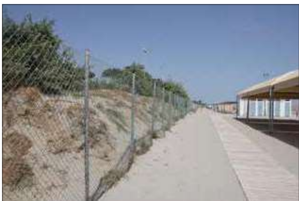
Accumulo di dune di sabbia all'interno del perimetro del giardino confinante con la spiaggia - sopralluogo 2023
