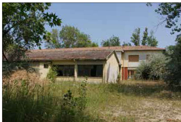
Lato Via C. Colombo, visibili infissi rotti e vegetazione non mantenuta - sopralluogo 2023
