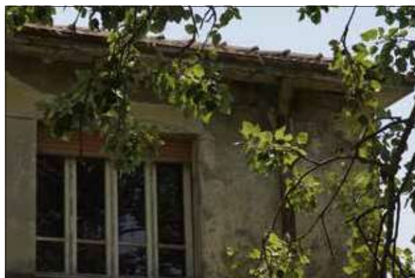
Murature ammalorate con distacco degli intonaci - sopr. 2023
