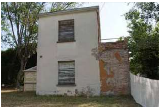
Distacco intonaco e muratura esposta - sopr. 2023
