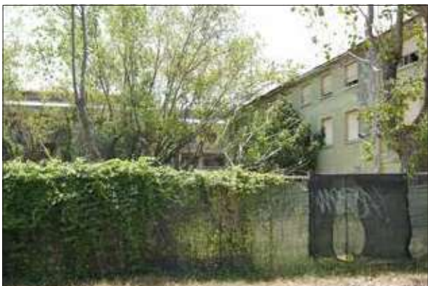
Giardino lato mare con alberi caduti contro l'edificio - sopr. 2023
