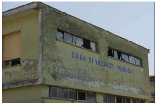
Vetri rotti delle finestre di facciata - sopralluogo 2023
