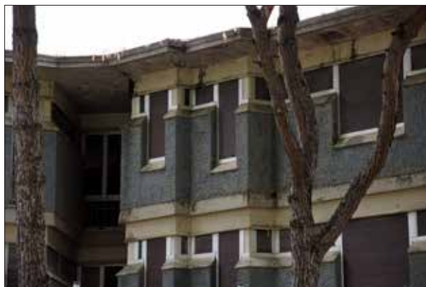
Alberi che sovrastano la copertura - sopralluogo 2023
