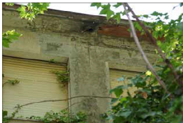
Grondaia mancante e distacco intonaco - sopralluogo 2023
