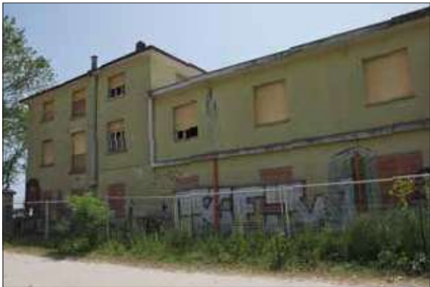
Lato su Via Tito Speri con segni di vandalismo - sopr. 2023
