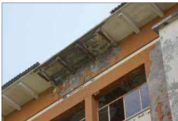
Distacchi intonaci interni e elementi della copertura - sopr. 2023
