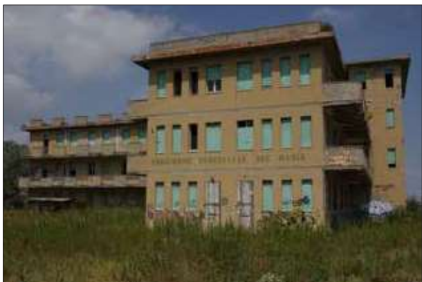
Segni di vandalismo diffusi - sopralluogo 2023
