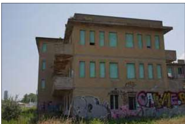
Ferri del sottotetto e dei balconi esposti - sopralluogo 2023
