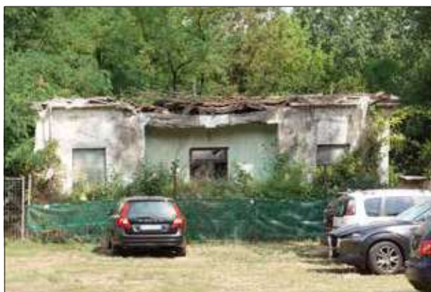
Edificio di servizio in avanzato stato di degrado - sopr. 2023
