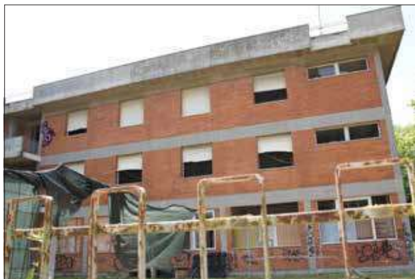
Facciata su Via C. Colombo con segni di vandalismo sopralluogo 2023
