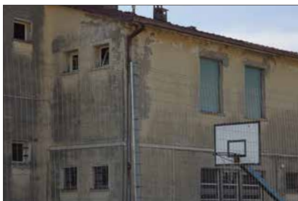
Lato Nord con intonaco rovinato - sopralluogo 2023
