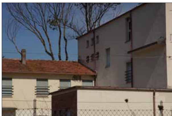
Particolare intonaco rovinato - sopralluogo 2023
