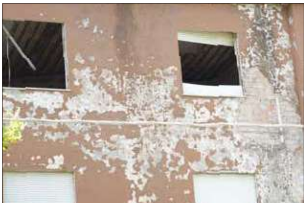
Travi dei solai esposte, distacco intonaco, mancanza di grondaie - sopralluogo 2023
