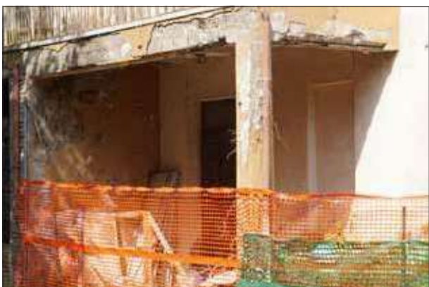
Elementi portanti esposti e distacchi - sopr. 2023
