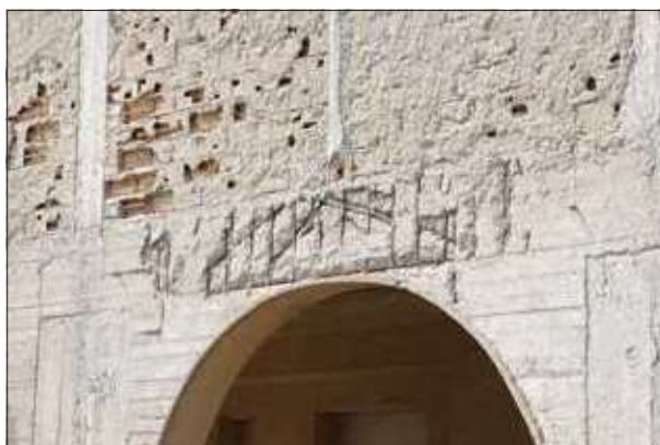
Elementi strutturali esposti e danneggiati -sopr. 2023
