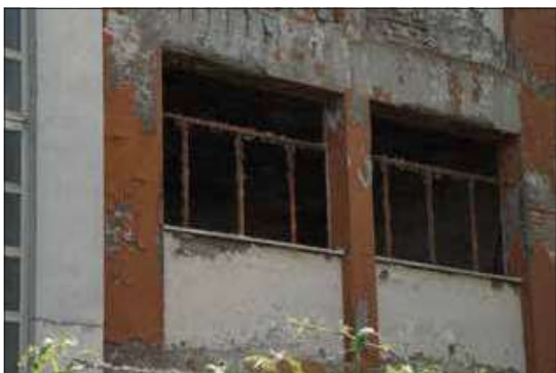
Ingente deterioramento anche degli interni - sopr. 2023
