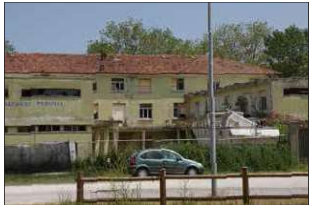
Facciata su Piazza Marco Polo, vegetazione sullo stabile sopralluogo 2023
