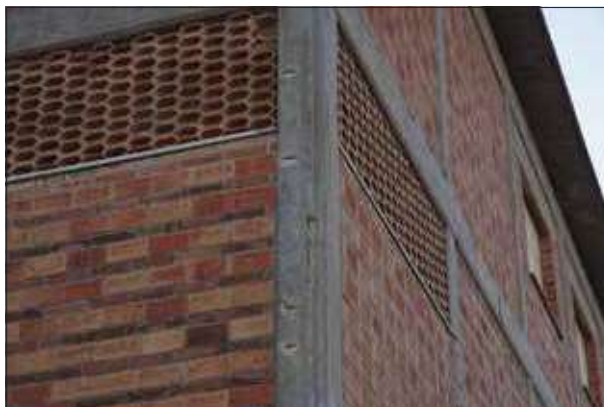
Dettaglio angolo con laterizi ad alveare rotti - sopr. 2023
