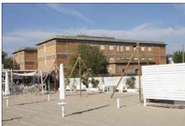
Foto dalla spiaggia, visibile vegetazione sulla copertura sopralluogo 2023
