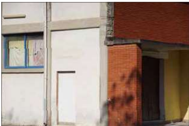
Cementi con ferri esposti - sopralluogo 2023
