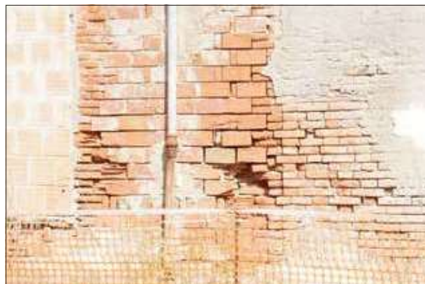
Muratura portante danneggiata - sopr. 2023
