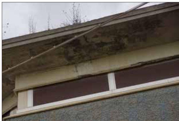
Vegetazione sul tetto, distacco intonaco ed esposizione ferri di armatura - sopralluogo 2023
