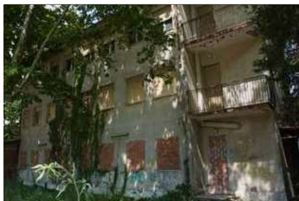
Vegetazione sulla facciata Via Pian del Carpine - sopr. 2023
