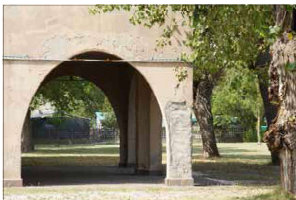
Pilastri portico con intonaco e copriferro mancante - sopr. 2023
