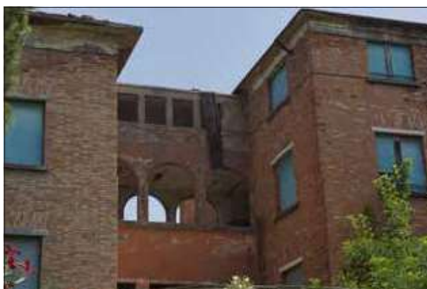
Degrado degli elementi architettonici, legni a sostegno delle piattabande delle finestre - sopralluogo 2023
