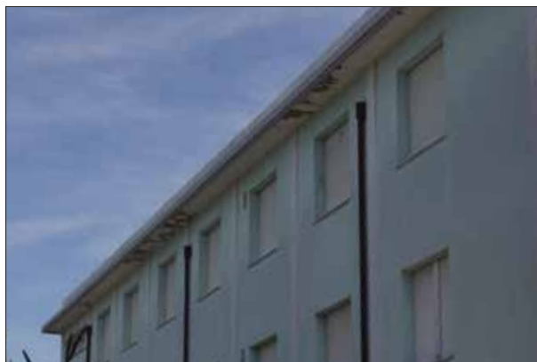
Dettaglio distacco intonaco nel sottotetto - sopr. 2023
