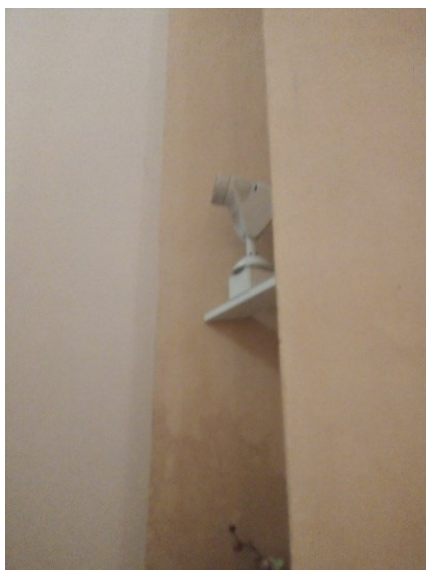
Figura 12 – Proiettore collocato a meno di due metri di altezza e nascosto per illuminare la pala di una cappella laterale
