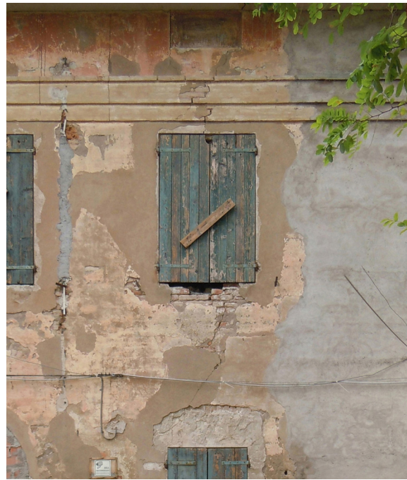
Fronte Est, lesioni a 45° orientate a sinistra
