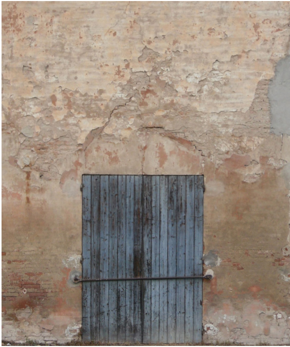
Fronte Sud, lesione sopra l'architrave dell'apertura principale nell'Ala Est
