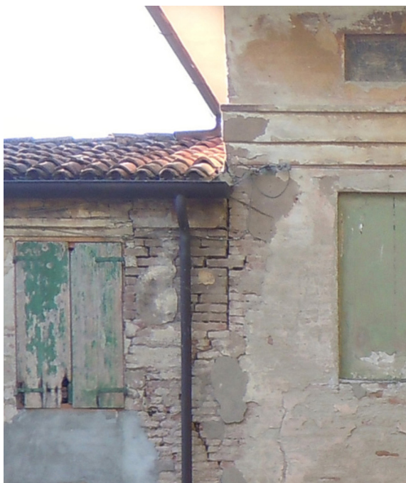
Fronte Nord, lesione nel punto di congiunzione tra i due fabbricati dell'Ala Ovest
