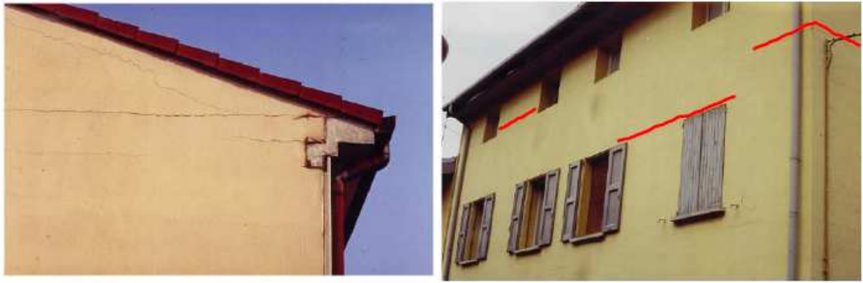
Fig. 1.22 - Tipiche fessurazioni nelle murature
