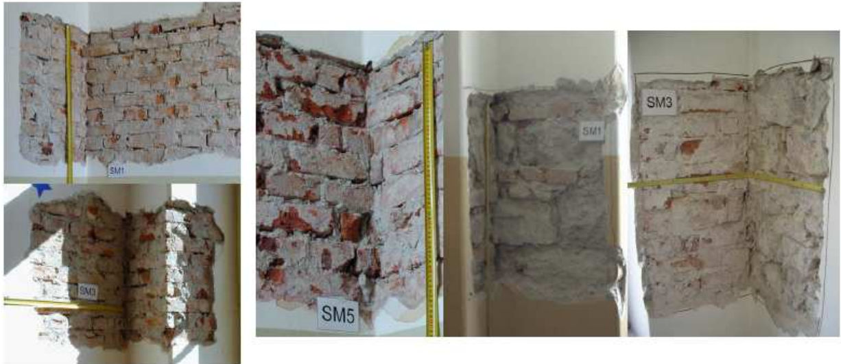
Fig. 5.3 - Scassi superficiali eseguiti su pareti in angolo di edifici in muratura
