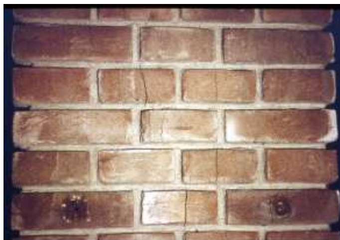
Fig. 2.2 - Tipico quadro fessurativo di una muratura soggetta a compressione assiale
