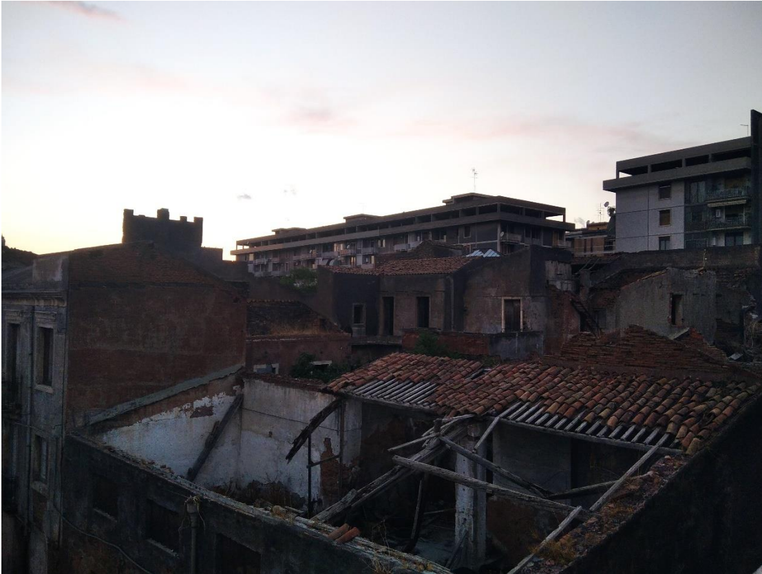
Fig. 15. Stato attuale di alcuni edifici situati a San Berillo Vecchio, Catania 2022.
