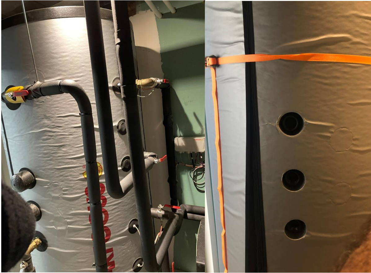
Figura 20: A sinistra l'accumulo termico SH prima delle connessioni fatte alle porte laterali e a destra le porte laterali non connesse.
