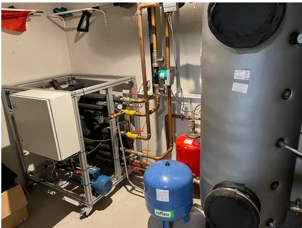
Figura 26: Serbatoio di accumulo freddo con PCM (a destra) collegato al VGE (a sinistra) dentro l'edificio della località di Porto.
