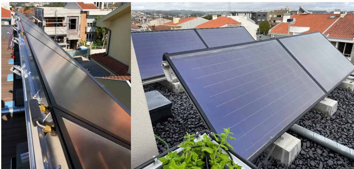
Figura 15: Porzione di campo di collettori solari installati sul tetto dell'edificio residenziale.
