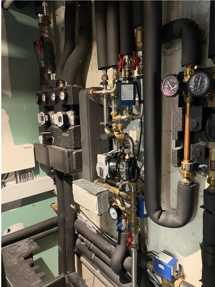
Figura 18: Sistema collegato al campo dei 9 collettori solari dove: a sinistra vi è lo scambiatore di calore; a destra le due pompe connesse da un lato al campo di collettori solari, dall'altro all'accumulo TES o al generatore del VGE.
