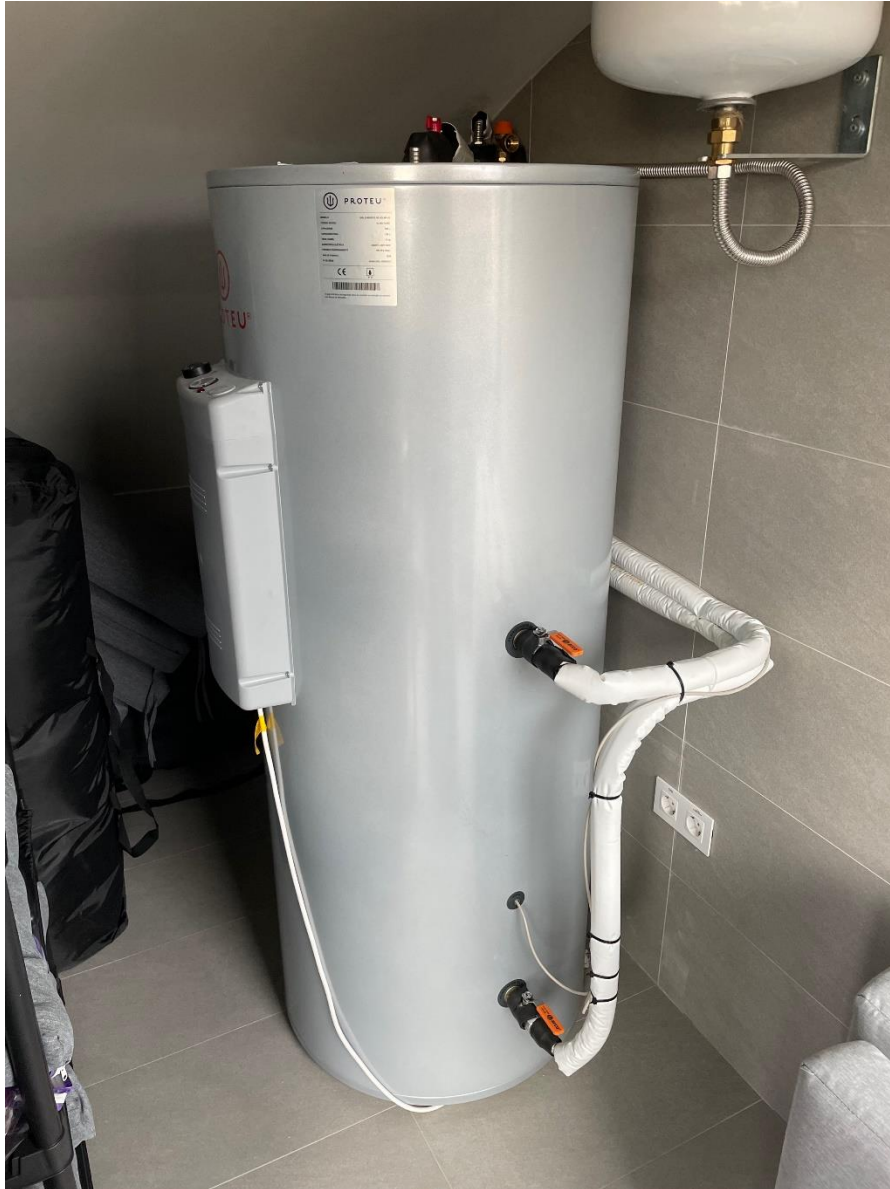
Figura 24: Accumulo DHW Tes installato nell'edificio della località di Porto.
