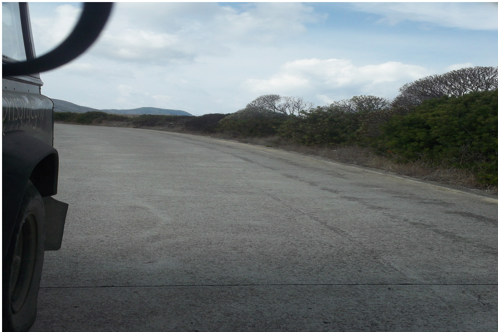
Fig. 2.8 Evidente carenza di opere di smaltimento delle acque a lato strada
