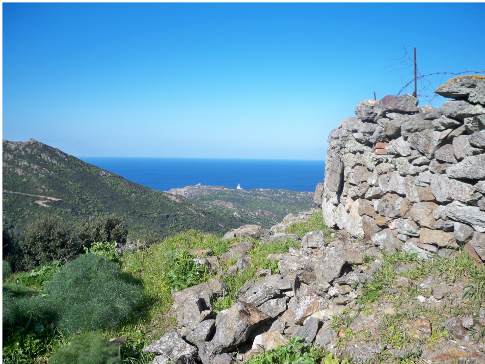
Fig.2.7: Crollo muro perimetrale
