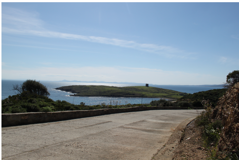
Fig. 2.10: Organi di ritenuta inappropriati e presenza di detriti nella carreggiata
