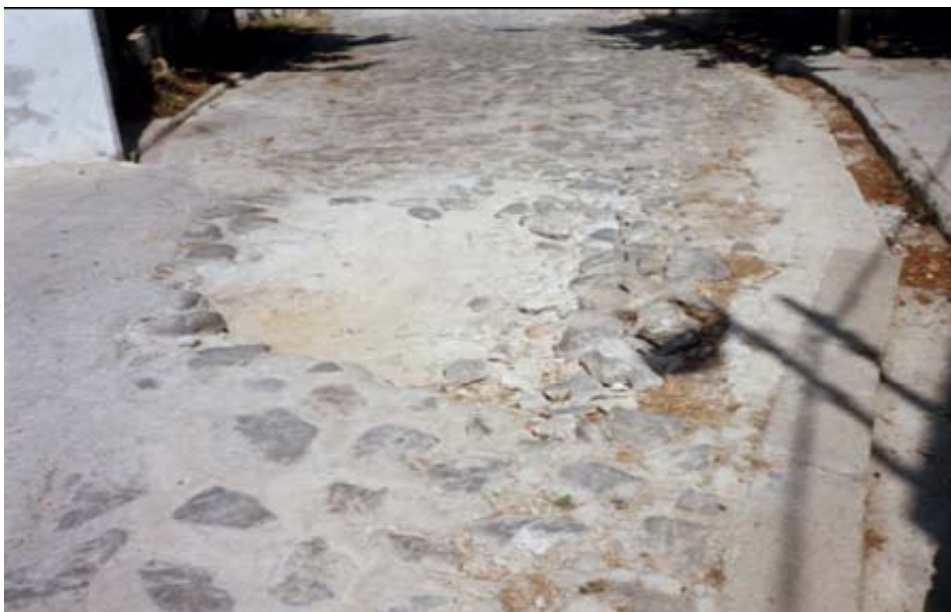
Fig. 2.15: pavimentazione all'interno del centro abitato con evidente necessità di manutenzione.
