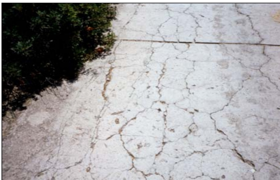
Fig.2.13: fenomeni di degrado sulla direttrice Cala Reale – Cala D'Oliva
