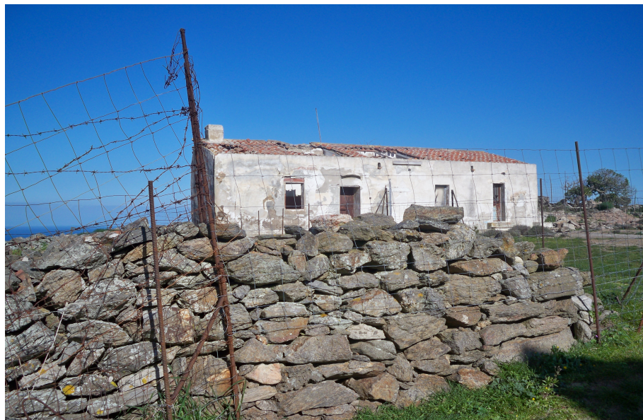
Fig. 2.6 : Crollo muri perimetrali
