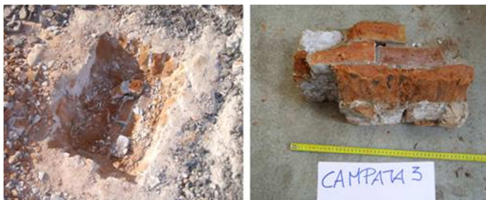
Figura 3.2 - Punto di prelievo e campione prelevato dalla campata C3
