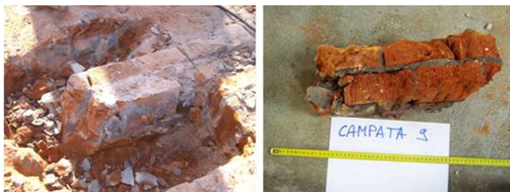
Figura 3.3 - Punto di prelievo e campione prelevato dalla campata C9
