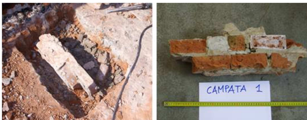
Figura 3.1 - Punto di prelievo e campione prelevato dalla campata C1
