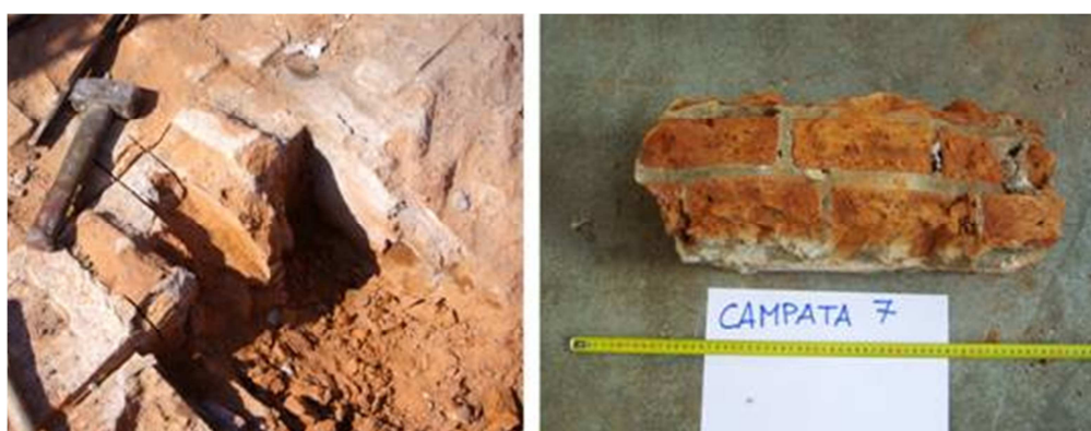
Figura 3.3. Errore. Nel documento non esiste testo dello stile specificato. 3 - Punto di prelievo e campione prelevato dalla campata C7
