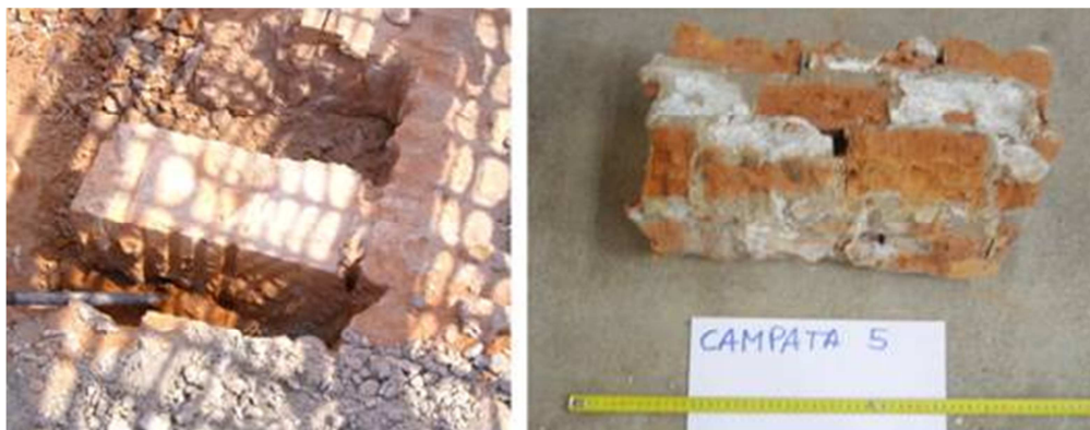
Figura 3.3- Punto di prelievo e campione prelevato dalla campata C5
