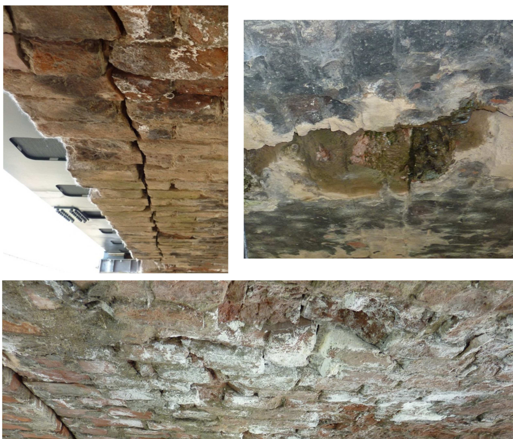
Figura 2.2 – Particolari di pezzi di volta deteriorati
