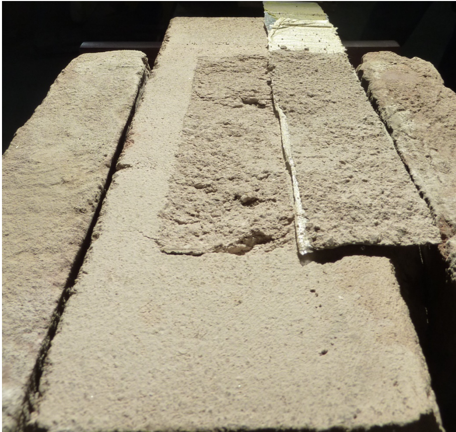
Figura 6.196 – Particolare della modalità di distacco del rinforzo (prova M4B1c).
