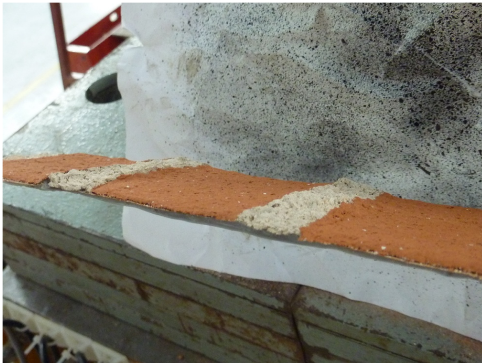
Figura 6.26 - Formazione di una vera e propria dentatura in corrispondenza dei letti di malta.
