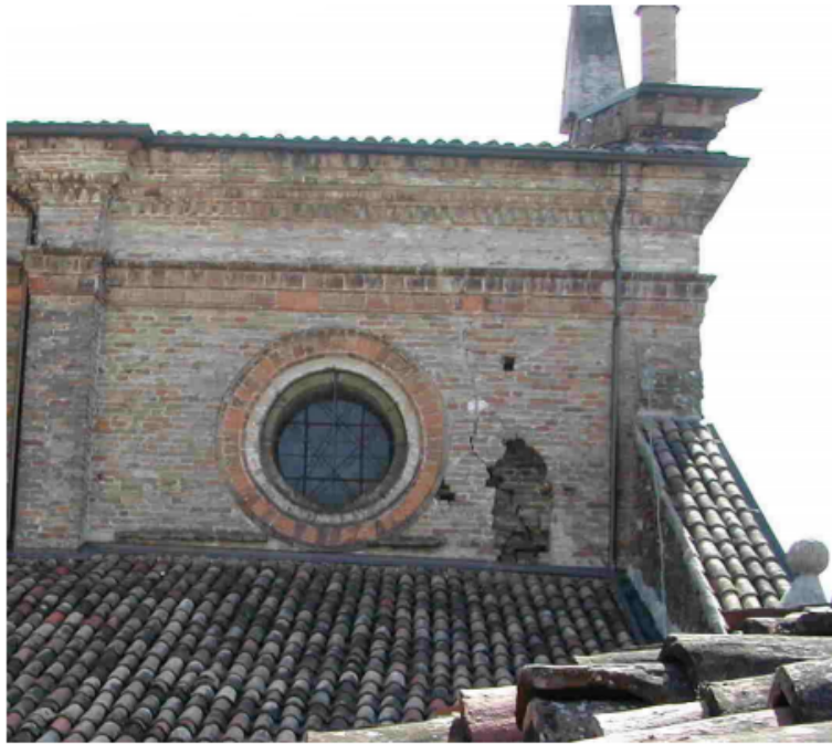
Fessura sulla parete esterna di una chiesa parrocchiale: l'accesso alla zona richiede l'ausilio di ponteggi o mezzi di sollevamento.
