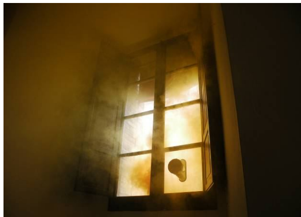
Figura 7.57: Visualizzazione delle infiltrazioni di aria nell'infisso W2F69 mediante l'utilizzo di un fumogeno.
