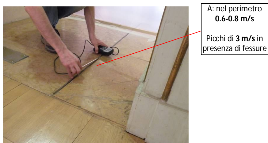
Figura 7.41: Infiltrazioni di aria rilevate nel condotto degli impianti nella porzione di pavimento in marmo della Sala dei Primitivi.
