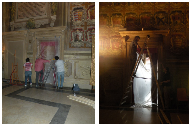
Figura 7.25: Installazione del telo in nylon sulle aperture presenti nella parete nord e nella parete est.
