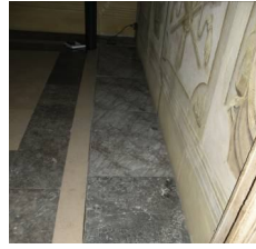
Figura 7.108: Condotto degli impianti nel pavimento della Sala Urbana.
