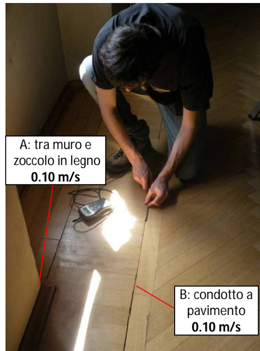
Figura 7.40: Infiltrazioni di aria rilevate nel pavimento in parquet della Sala dei Primitivi.
