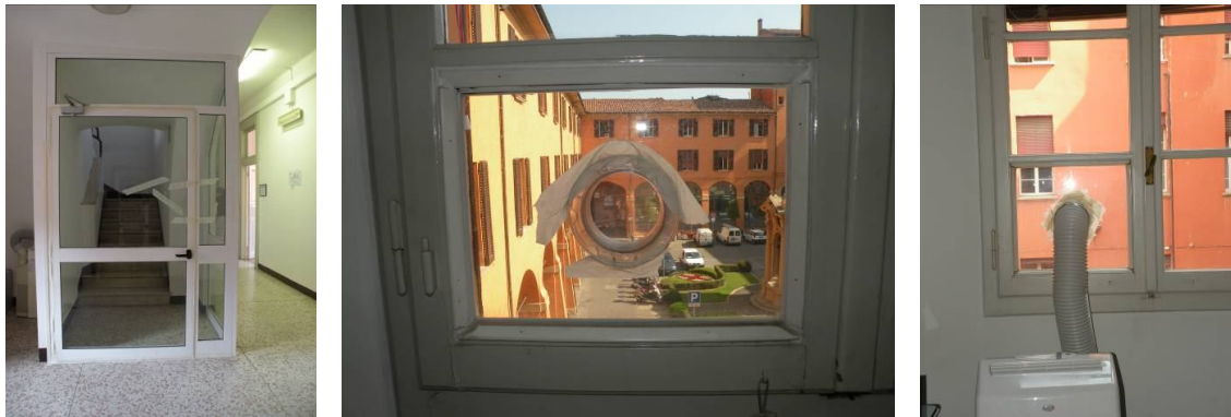
Figura 7.52: Porta d'accesso al vano scala e fori per l'impianto di condizionamento sigillati con nastro adesivo.
