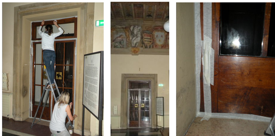
Figura 7.87: Sigillatura della porta vetrata presente nella Sala degli Svizzeri.
