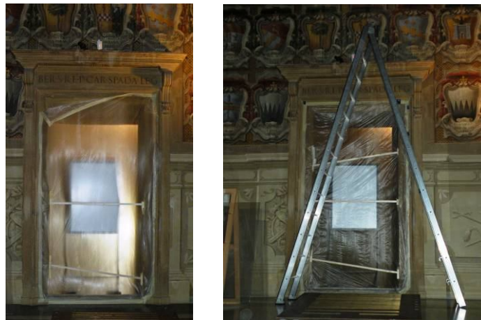
Figura 7.29: Cedimento, in sommità, della sigillatura dell'apertura presente nella parete sud e relativo rafforzamento della chiusura con ulteriore aste in legno.
