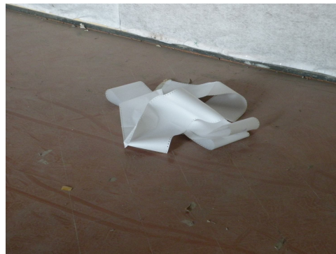
Figura 4.24: Striscia di carta staccatasi dal soffitto.
