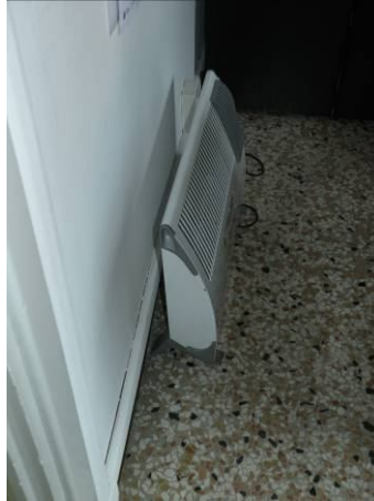
Figura 7.101: Stufa elettrica utilizzata per il riscaldamento.
