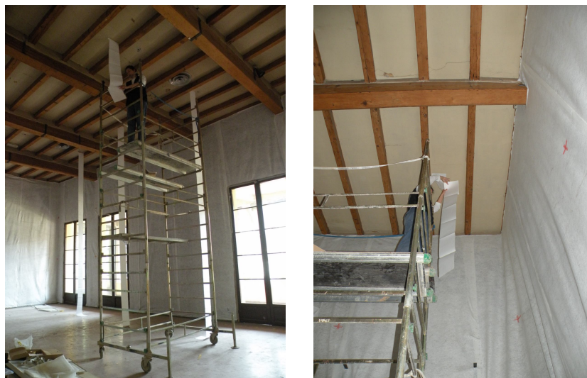
Figura 4.13: Disposizione delle strisce di carta al soffitto del salone mediante l'utilizzo di un trabattello.
