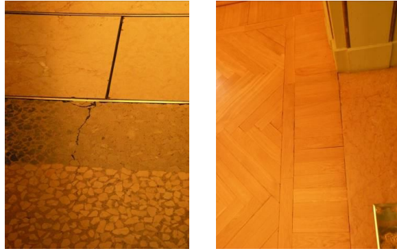
Figura 7.111: Condotto degli impianti nel pavimento in marmo della Sala Vidoniana e nel parquet della Sala dei Primitivi.
