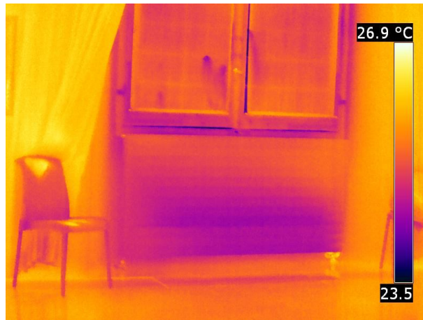
Figura 7.95: Rilievi con termocamera su infisso e condotto degli impianti nella Sala n°18.
