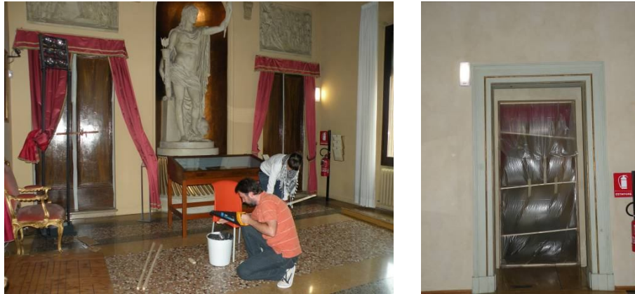
Figura 7.115: Preparazione dei telai in legno ed esempio di una chiusura realizzata mediante aste di legno, telo in nylon e nastro adesivo.
