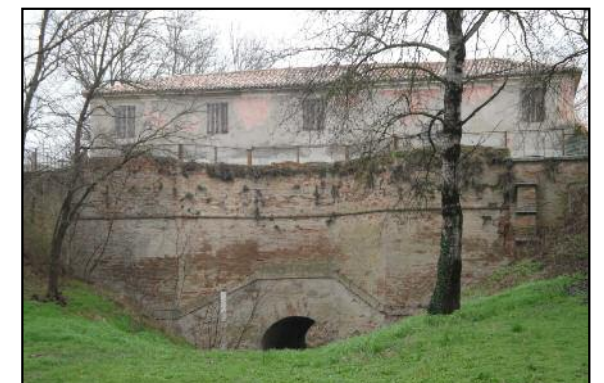
8 - Chiavica Emissaria ( lato sud-ovest )
