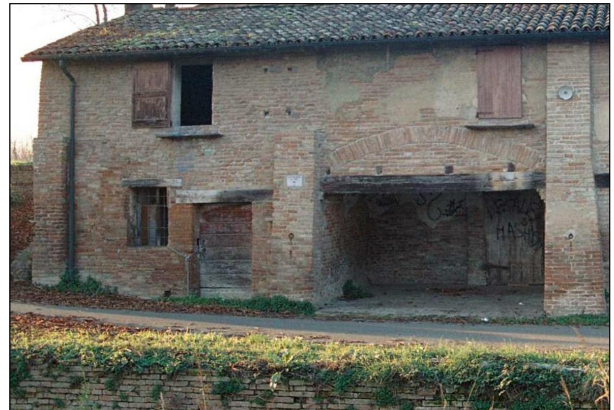
Aperture di finestre con piattabanda e architrave in legno, al piano terra.
