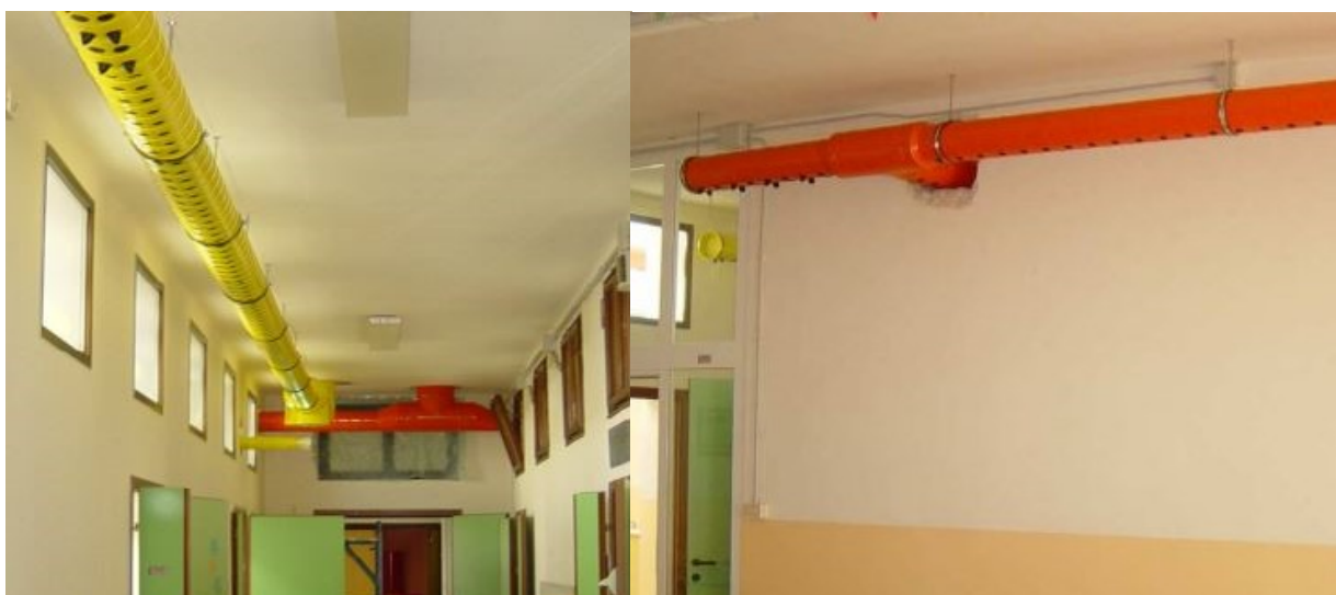
Figura 29: Canalizzazioni all'interno della scuola [fonte: vedi nota 99]
