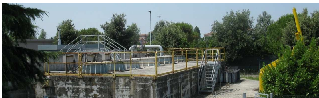
Figura 43 Impianto Idrovoro Comparto Nord.
