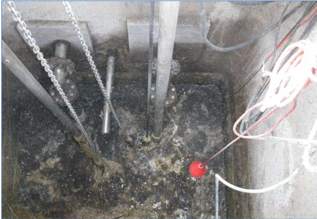
Figura 33 Vasca alloggio Pompe
