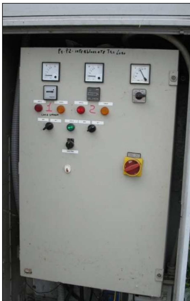
Figura 38 Centralina di comando Pompe
