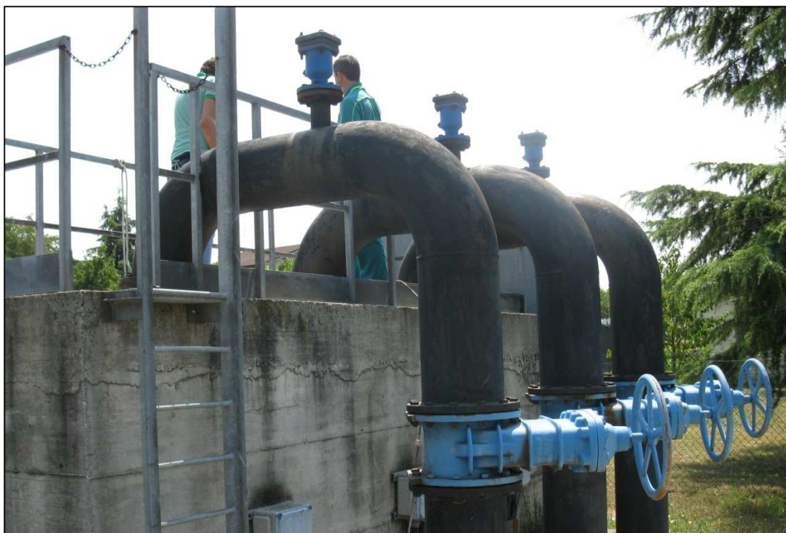
Figura 42 Impianto di sollevamento acque nere.
