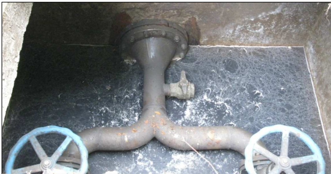
Figura 39 Collettore di mandata impianto di sollevamento S.Michele 4
