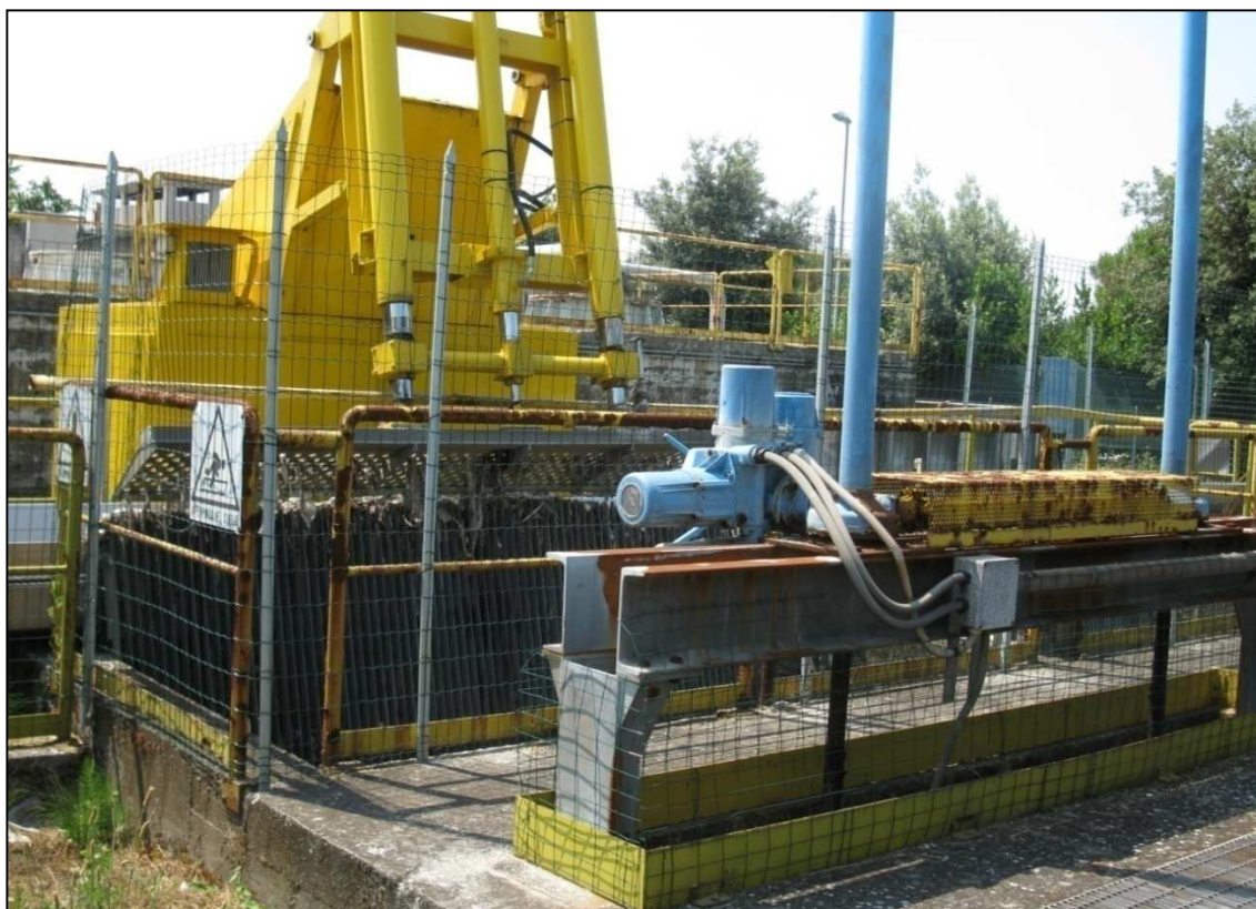
Figura 44 Sgrigliatore a monte dell'impianto idrovoro
