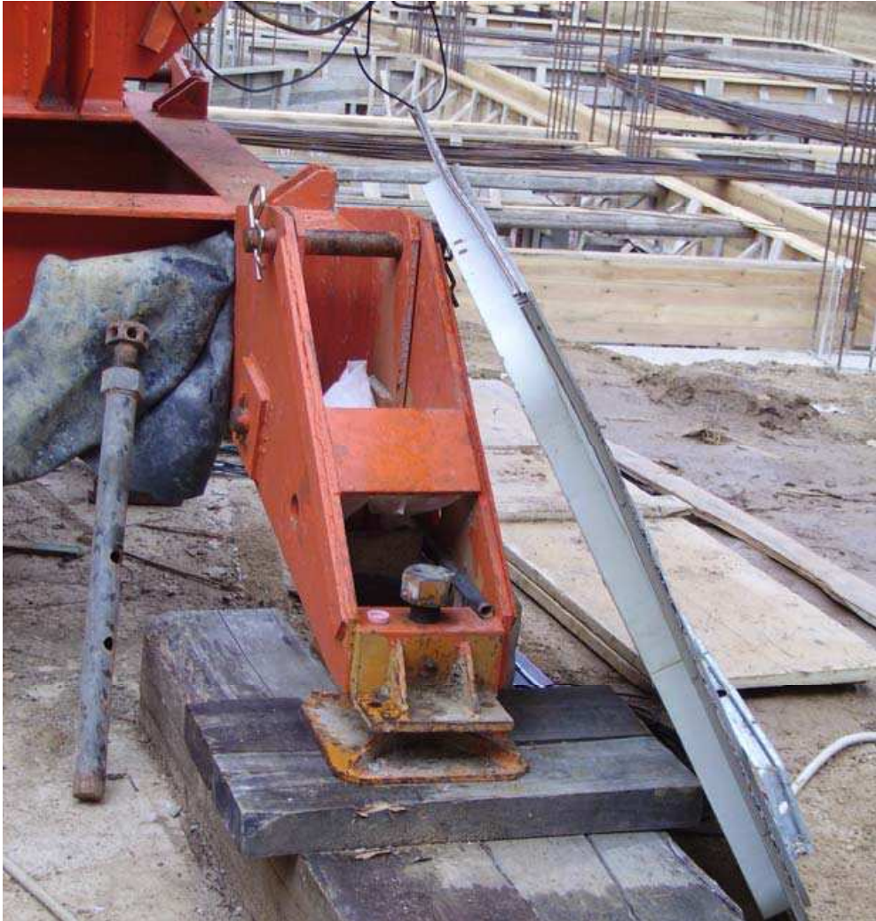
Figura 3.8 Tipo di appoggio della gru; tale situazione è però a rischio
