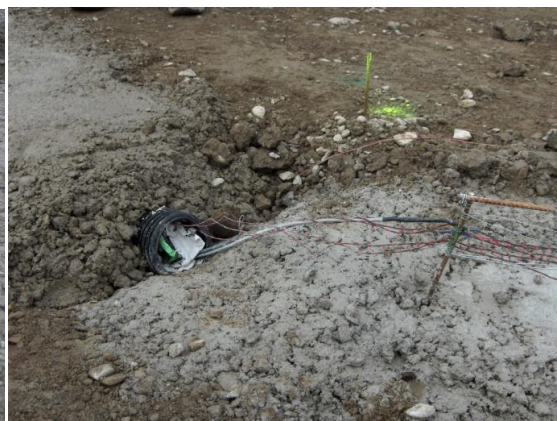
Figura 91: Protezione dei tubi da infiltrazioni di cls.
