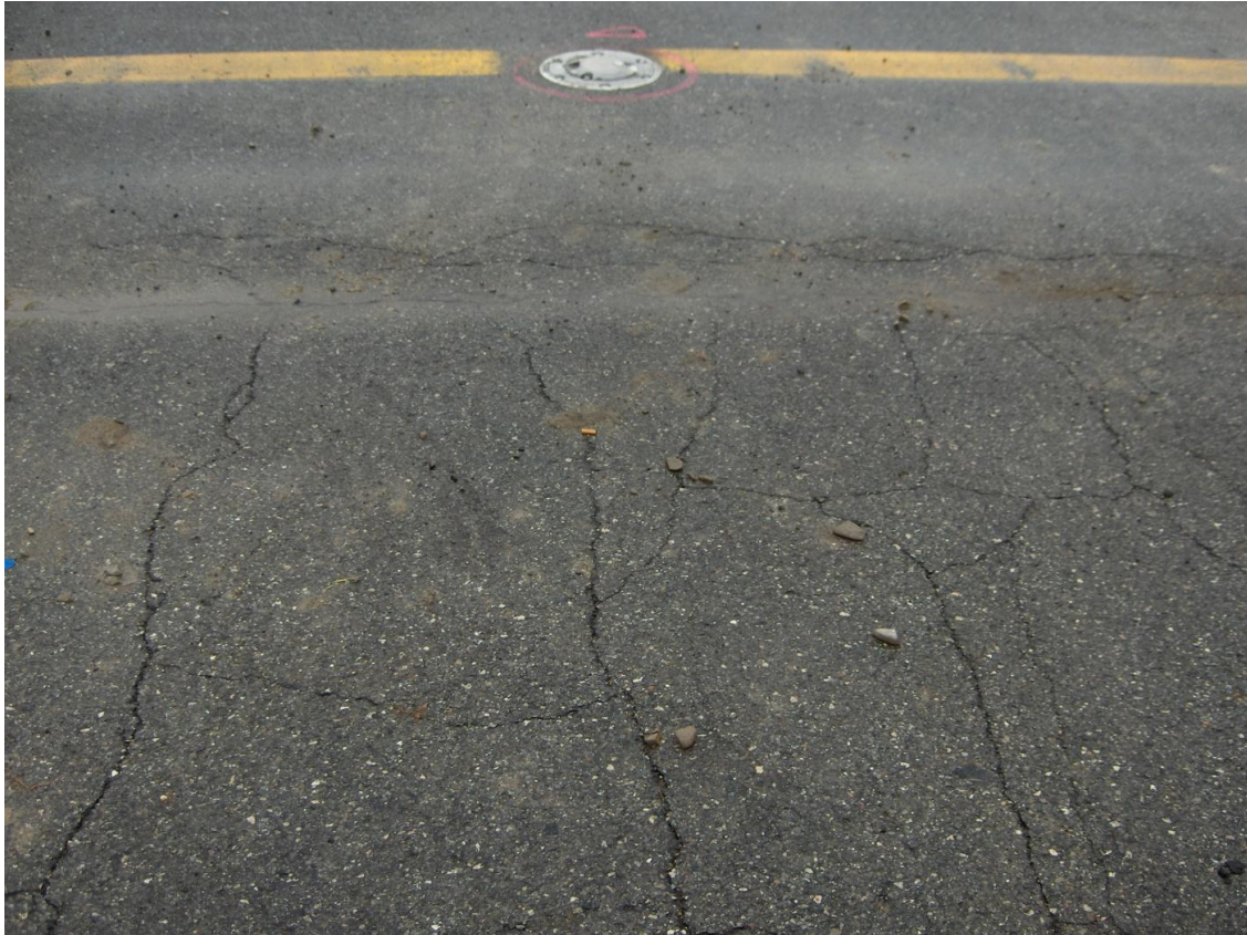
Figura 85: Fessurazione superficiale dello strato bitumoso nella vecchia pavimentazione.
