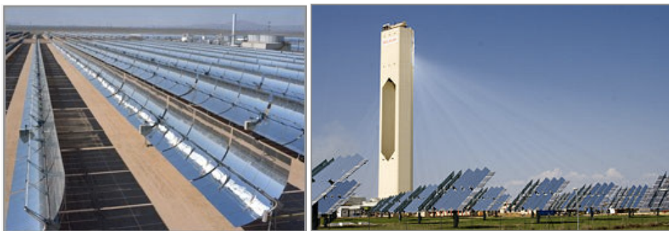
Due immagini di impianti solare termodinamici. A sinistra una centrale con concentratori parabolici lineare, a destra una centrale solare a torre.
