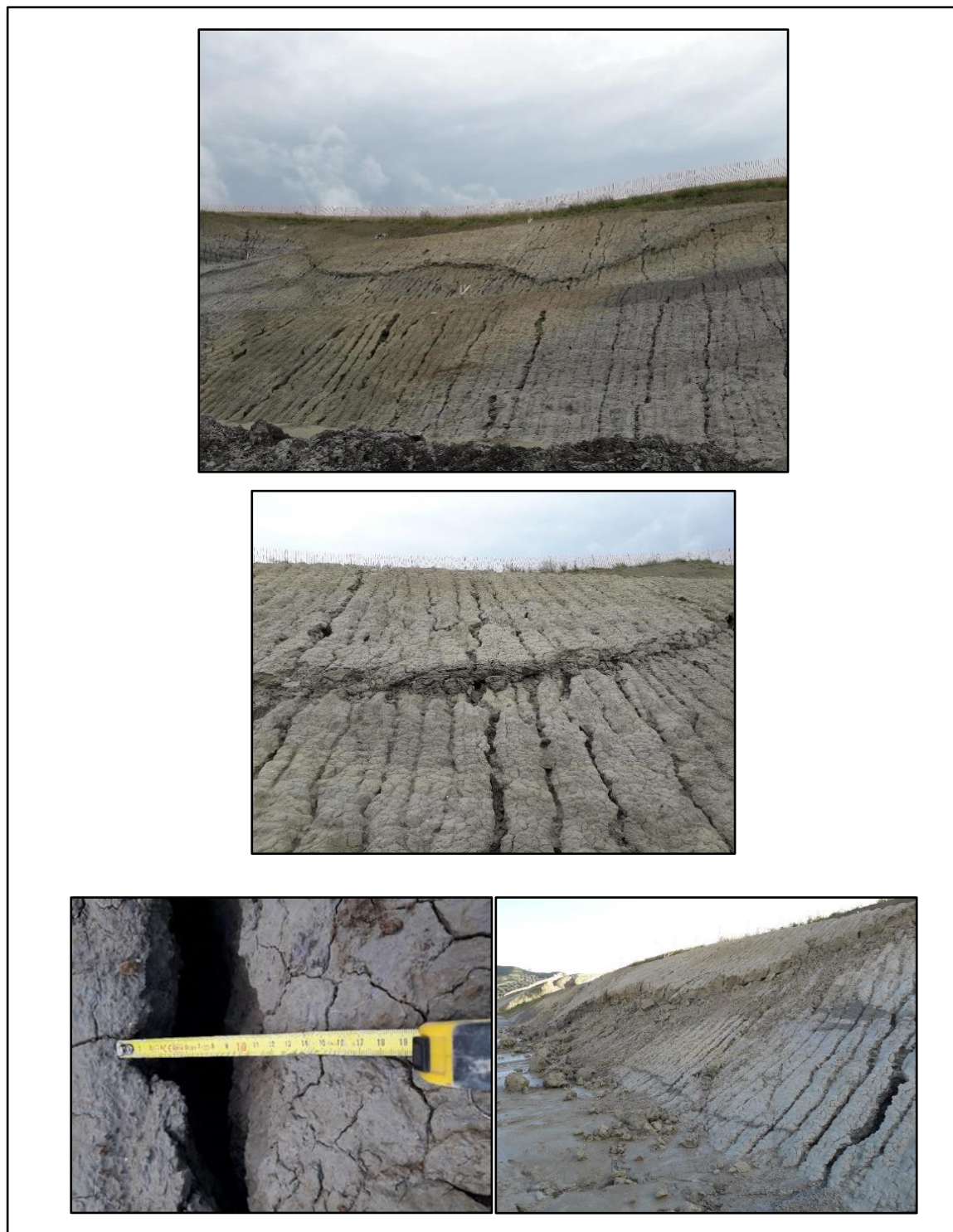
Figura 3.14 In alto e al centro è mostrata la dislocazione tra le pk 2+025 e 2+043 al 19/11/2018. In basso a destra l'evoluzione del dissesto sul fronte di scavo tra le pk 2+000 e 2+050 al 28/11/2018 di cui si riporta un particolare della frattura nella foto in basso a sinistra, (Geol. Merenda, 2018).
