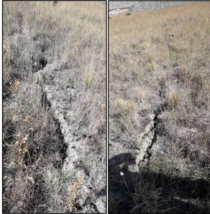
Figura 3.8 Linee di frattura rilevate in corrispondenza delle corone dei corpi di frana, (Geol. Merenda, agosto 2018).
