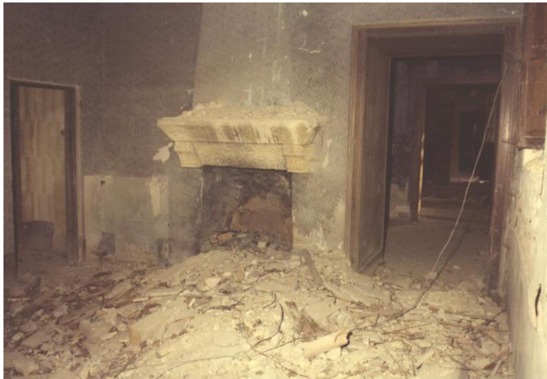
Archivio fotografico Servizio Progettazione e Manutenzione Fabbricati, Provincia FC - Anno 1984 Stato di conservazione interna in cui si trovava l'edificio
