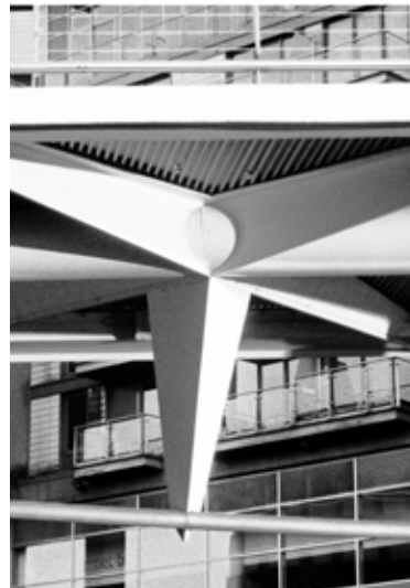
F12: http://4.bp.blogspot.com/Spinning2.jpg Nodo interno dell'impalcato reticolare
