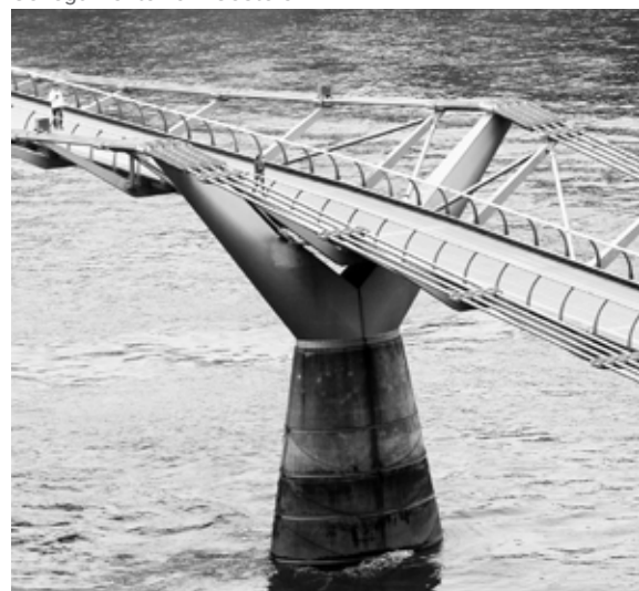
F8: httpwww.vosizneias.comwp-content/uploads/201208/London-Olympics-Effec_sham.jpg Collegamento funi-pile (l'impalcato è scollegato dalle pile)
