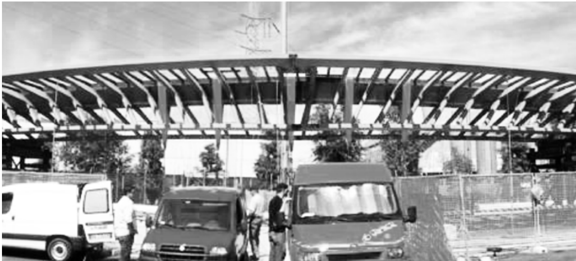
F11: G.ROMANO-C.ROMANO-L.ZIERO, Il IV ponte sul canal grande a Venezia, 2007 Vista laterale arco Vierendell in fase di montaggio
