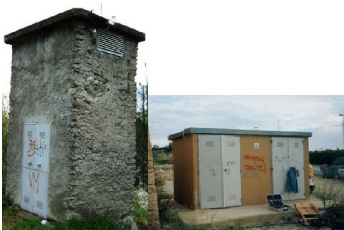
Figura 9: A sinistra un esempio di cabina ENEL in muratura (stazione di Aprica, SO), a destra un esempio di cabina ENEL prefabbricata in cemento armato (stazione di Augusta, SR).
