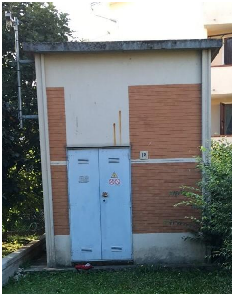
Figura 28: Cabina ENEL che ospita la stazione NAPOLI e che ha ospitato per circa cinque mesi la stazione TEMPO (Castellaro, 2019).
