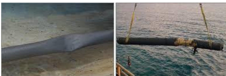
Figura 27 - Sezioni di pipeline danneggiate da un'ancora trascinata
