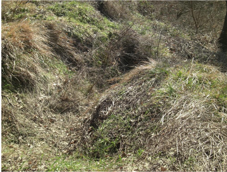
Figura 5.15 Distacchi di materiale nel ciglio della scarpata di Le Celle
