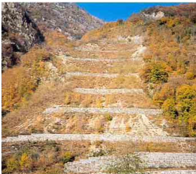
Figura 6.3 Esempio di versante stabilizzato con gabbionate (Atlante APAT 2002)
