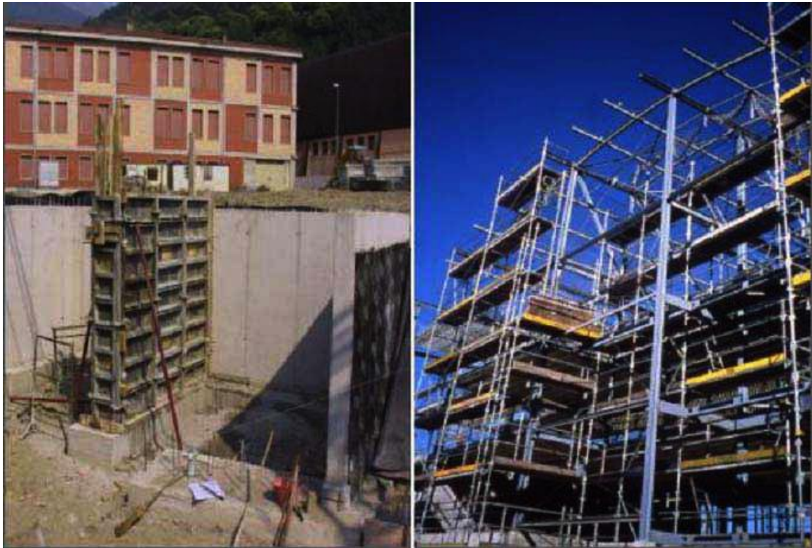
Fig.14 – Differenza tra cantiere tradizionale (a sinistra) e cantiere di una costruzione stratificata a secco (a destra)
