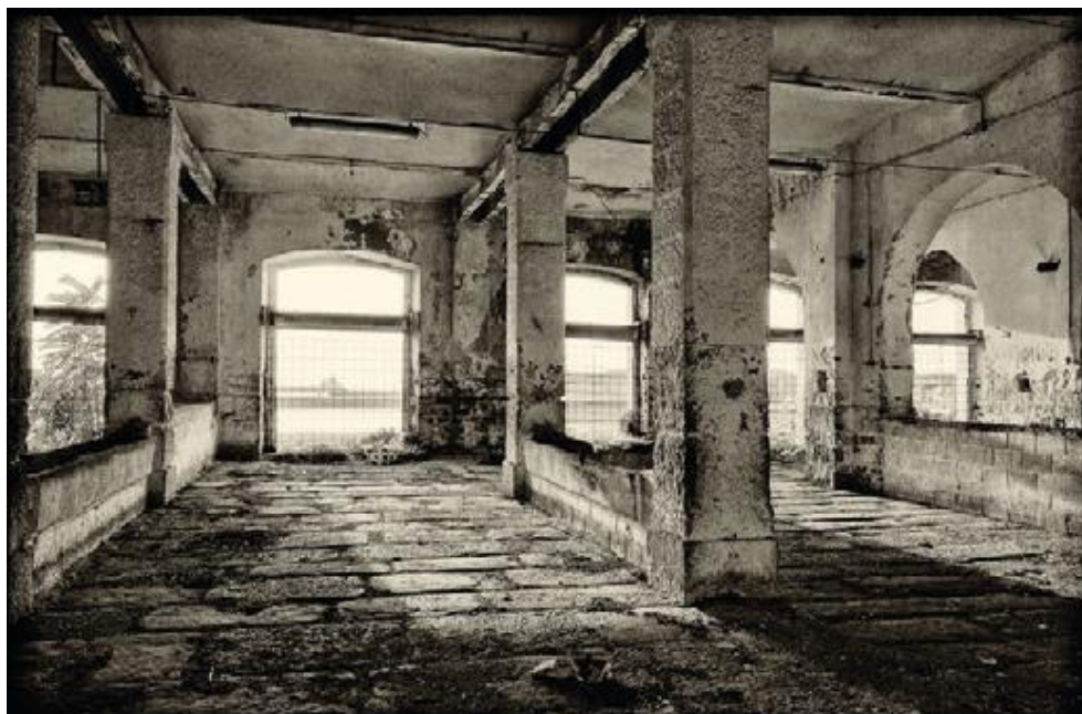
Fig.1.16 Immagine della parte interna dell'edificio del Porto Vecchio di Trieste preso in esame
