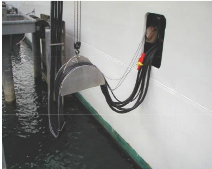
Figura 1.16 cavo di collegamento nave-banchina
