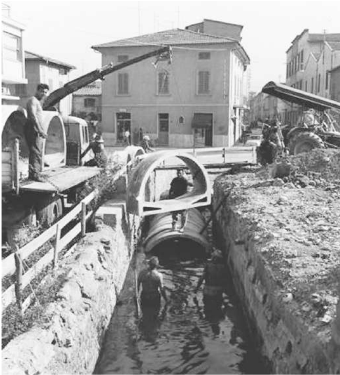
"Canalizzazione e copertura di gora tra via Strozzi e via Marini, 1954" (foto di Renato Bencini) disponibili su: foto.aft.it
