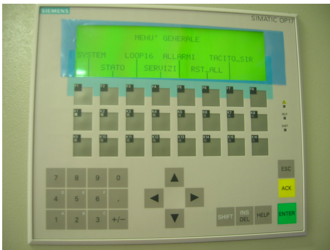
fig. 2.12 pannello operatore dell'impianto di addensamento
