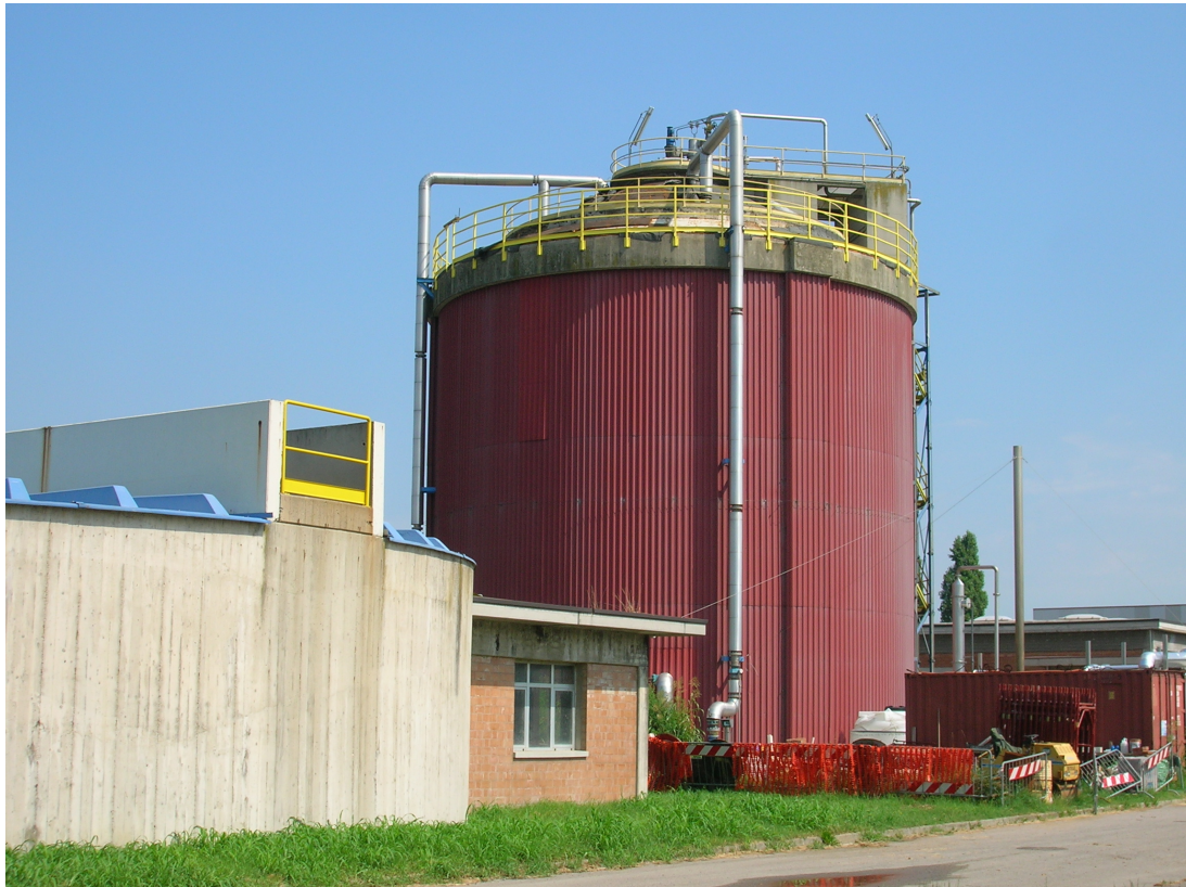
fig. 1.2 digestore anaerobico dell'impianto di depurazione Aimag di Carpi
