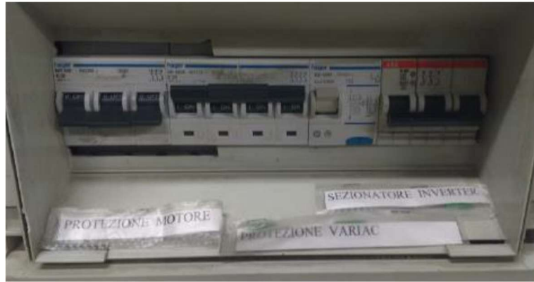
Figura 3-26 Quadro generale con i tre interruttori: protezione motore, protezione variac, sezionatore inverter.
