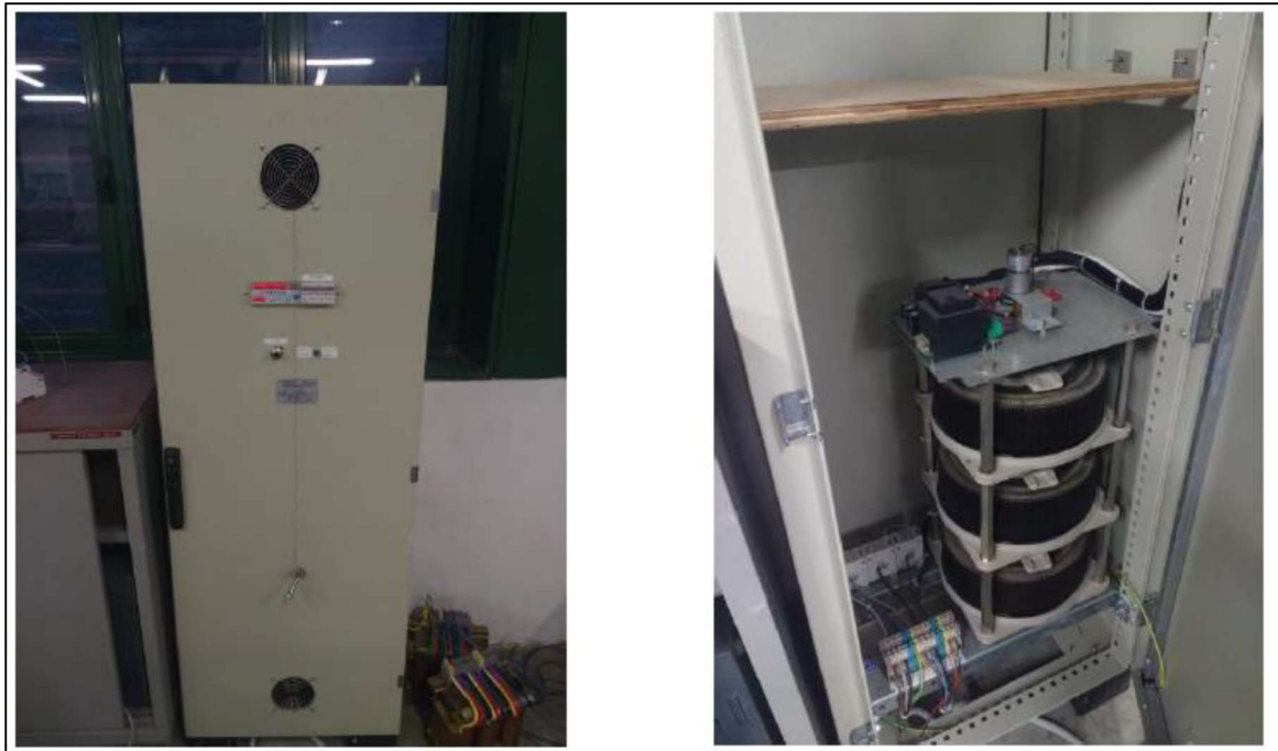
Figura 3-24 Variac di alimentazione. Vista esterna (sinistra) e vista interna (destra).
