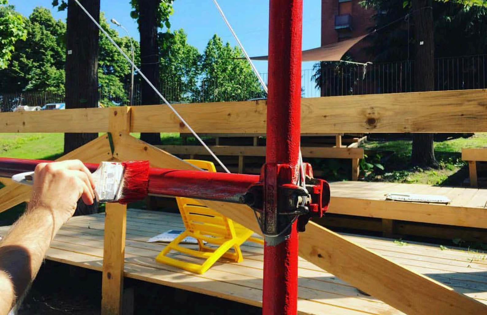
(IMMAGINI SOPRA) VOLONTARI TINTEGGIANO LE PARETI E LE STRUTTURE METALLICHE DURANTE UN GIORNO IN-CANTIERE
