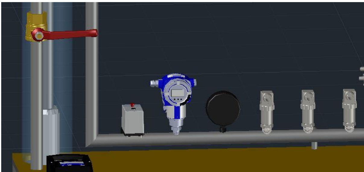
Figura 57 - tratto orizzontale del circuito su cui sono stati installati gli strumenti
