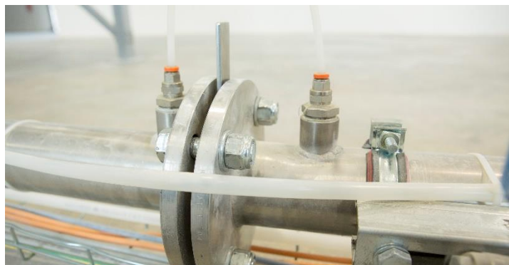
Figura 59 - esempio di orifizio tarato installato in Technosilos S.N.C.(Forlì-Cesena)
