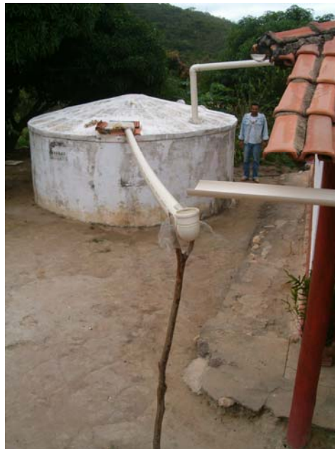
Cisterna per la raccolta dell'acqua piovana, Brasile
