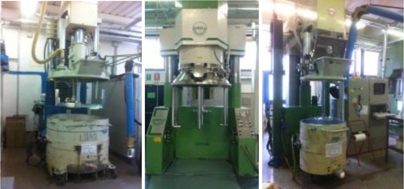
Figura 35 Miscelatori verticali del reparto siliconi.
