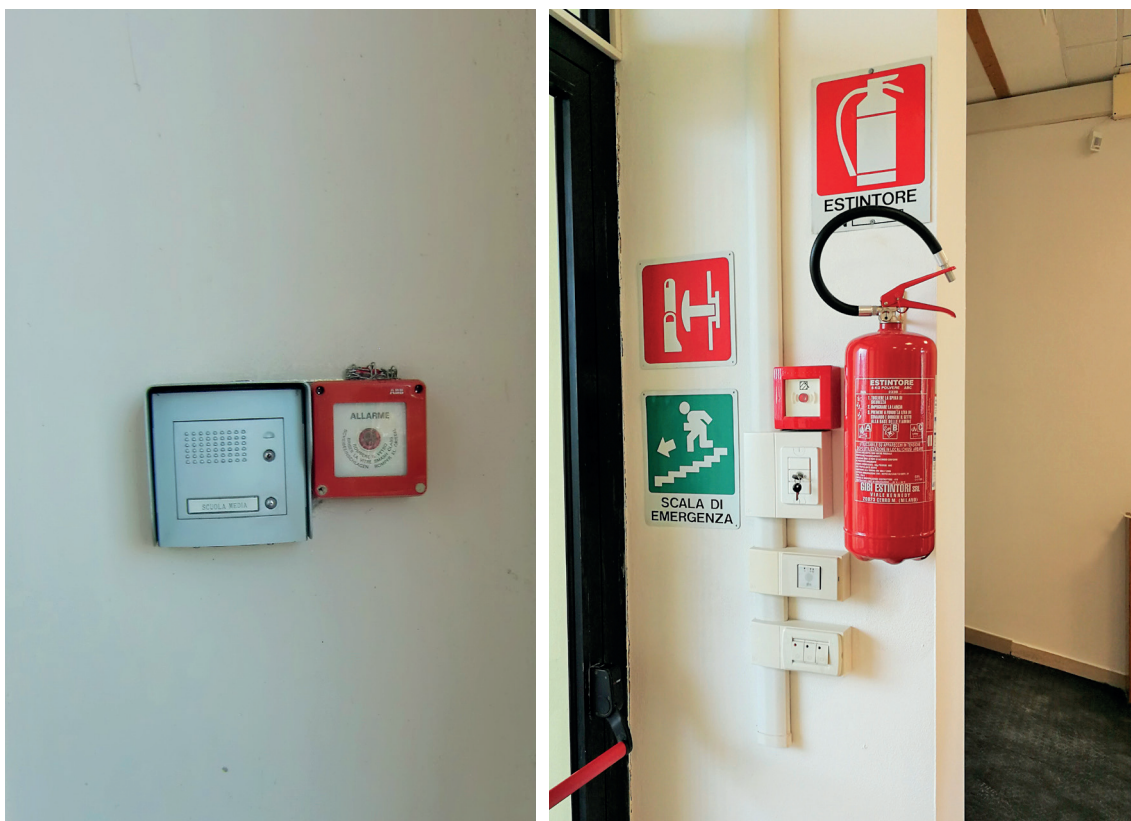
Figura 6.15, Figura 6.16 - Dettaglio di alcuni presidi antincendio disposti per la scuola
