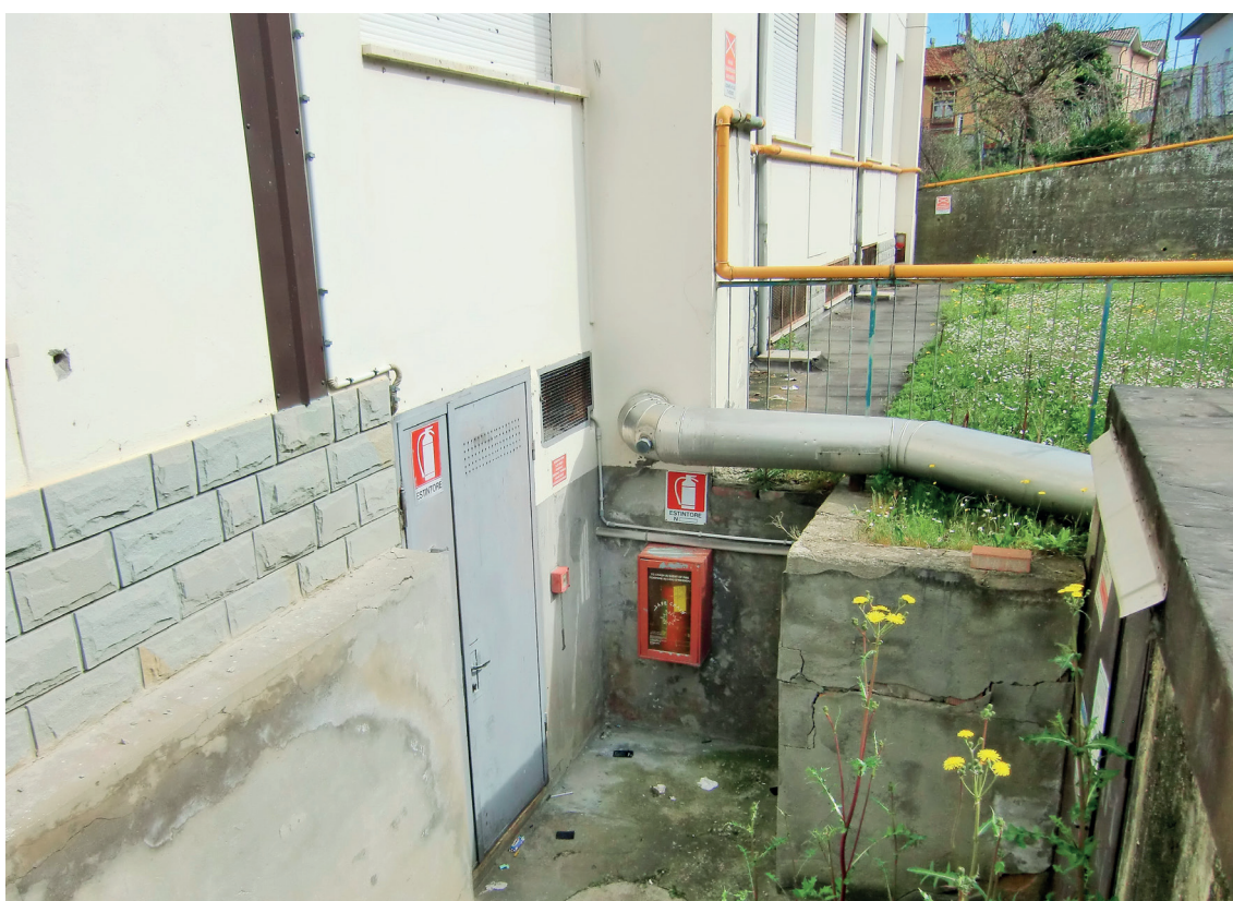
Figura 6.11 - Vista esterna lato Sud-Est: dettaglio della porta sul retro di collegamento ai vani tecnici
