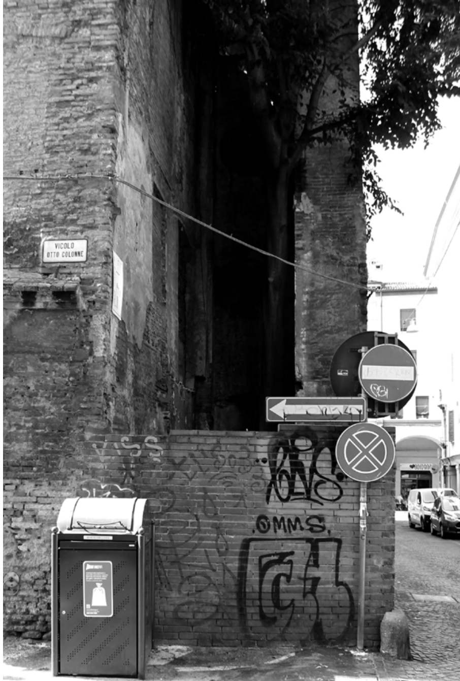
Retro del'edificio: un albero cresce adiacente al muro
