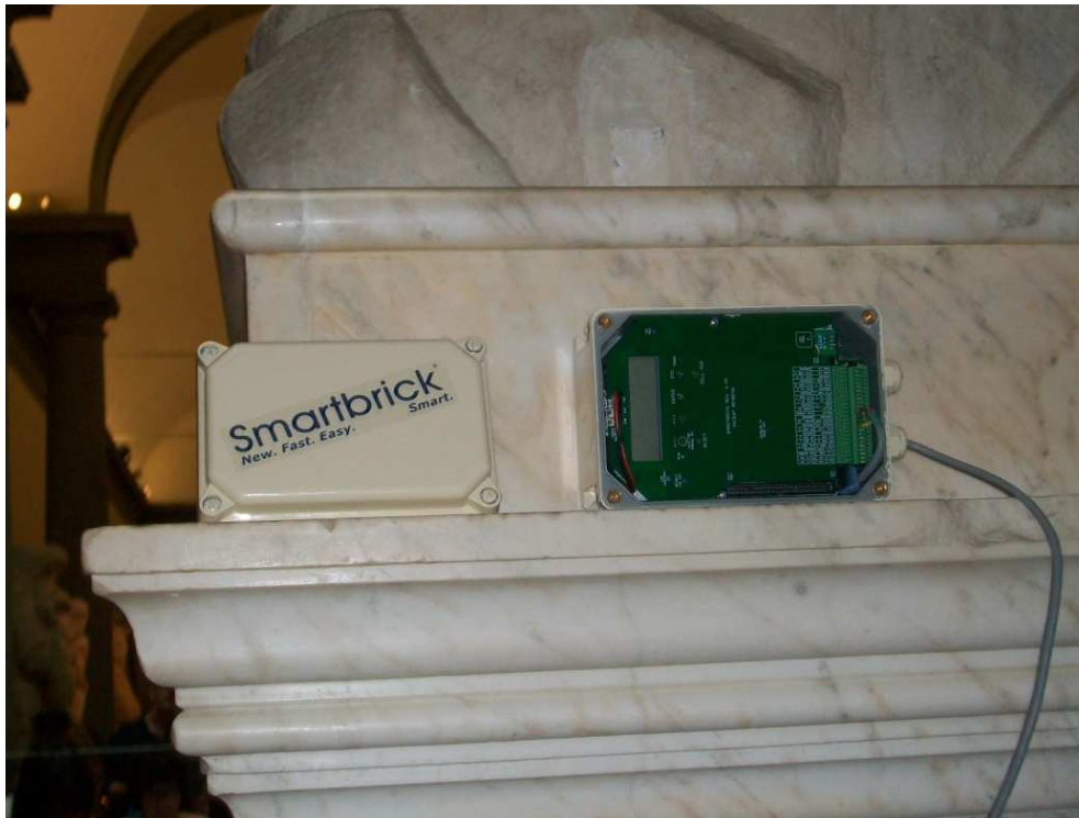
Fig 3.13 – Smartbrick installato sul basamento.
