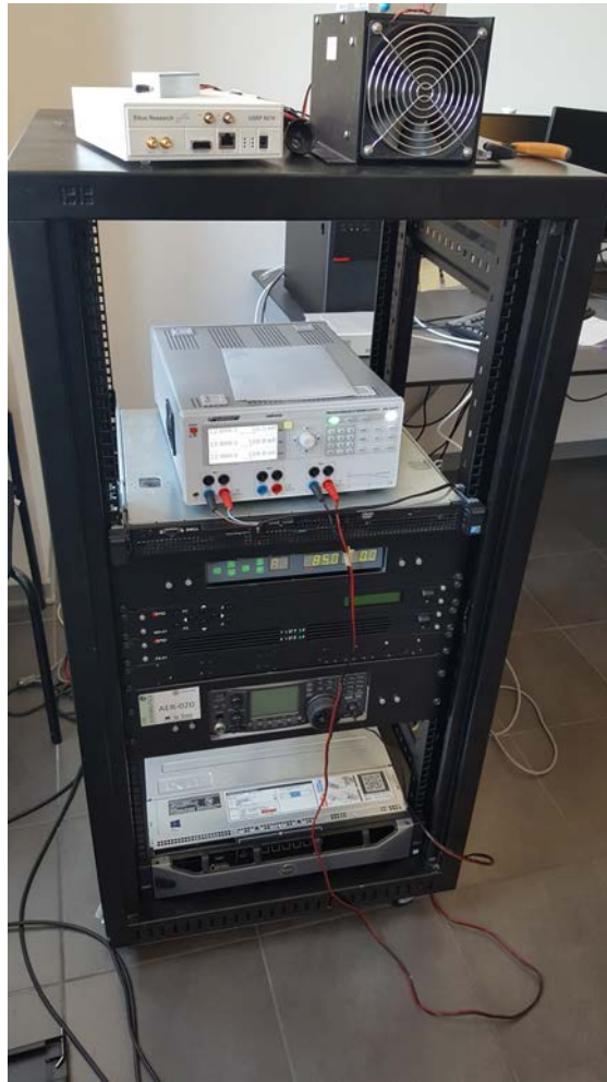
Figura 3.2: Rack con una parte della strumentazione
