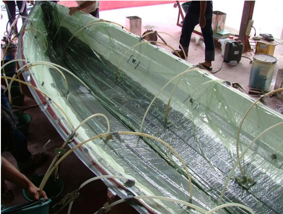
10 – Processo VIP durante la fase di impregnazione (fronte di resina che avanza in verde più scuro), immagine tratta da BoatDesign
