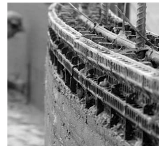
Leaking formwork: levigatura superficie esterna
