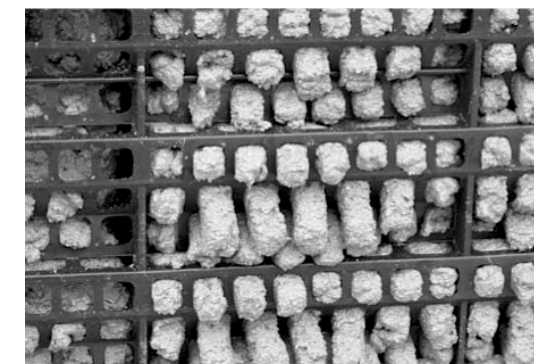
Leaking formwork: fuoriuscita del materiale dai fori del cassero
