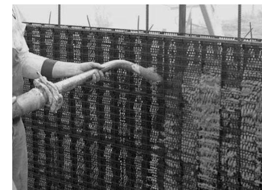
Leaking formwork: getto del materiale fluido di filling
